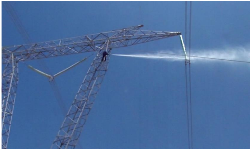
Figura 3a: Segunda Posición de lavado, personal se ubica a la altura del punto medio de la cadena de aisladores, a fin de alcanzar el punto más alto de la Cadena .
