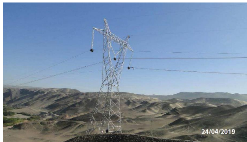
Figura N° 61. Sistema de transmisión – 1. Fuente: Propia.
