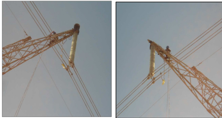
Fotos 1 y 2 : Aterramiento de líneas.
