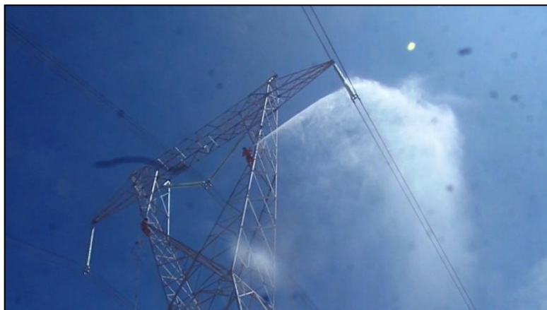
Figura 4: Para el lavado de las cadenas verticales el operador se posiciona entre las ventanas superior e inferior de la estructura autosoportada.
