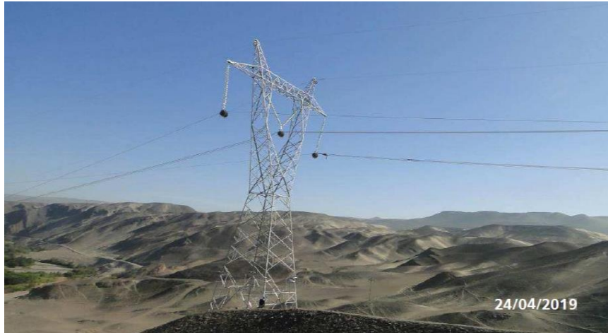
Figura N° 62. Sistema de transmisión – 2. Fuente: Propia.
