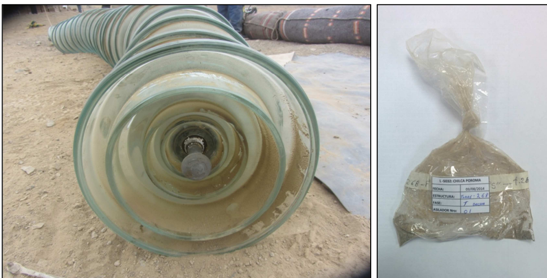
Muestra de contaminación obtenida de la torre 269 Fase-T.
