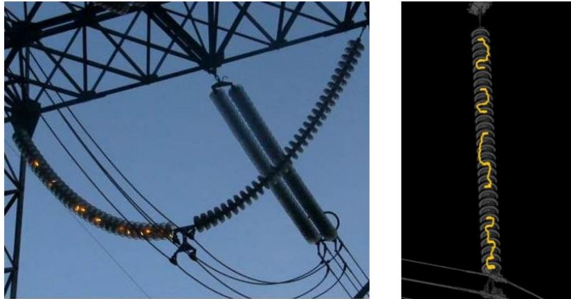
Figura N° 59. Nivel de efluvo 4. Fuente: Propia
