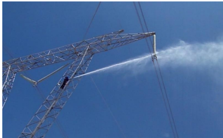
Figura 2: Primera Posición de Lavado, personal se ubica por debajo del aislador que se encuentra en la posición más bajo de la cadena de aisladores.
