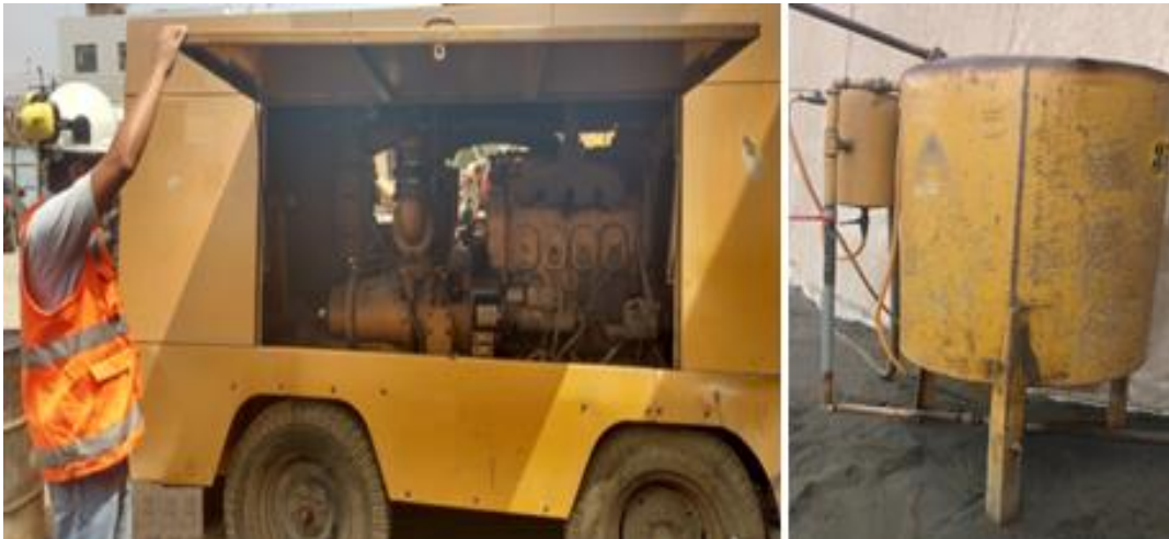
Figura 15. Compresora y tolva Fuente: elaboración propia
