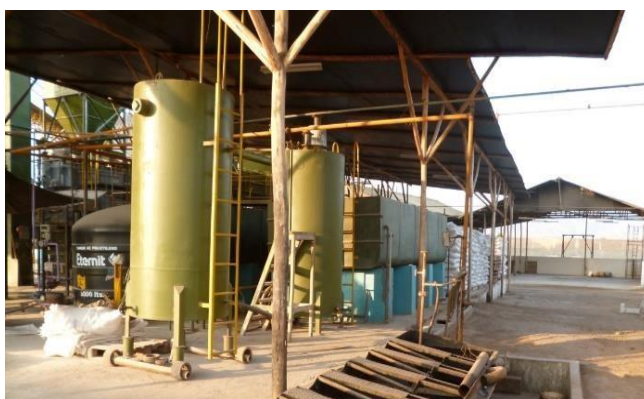
Figura 10.18: TANQUES DE ACEITE Y/ O GRASA
