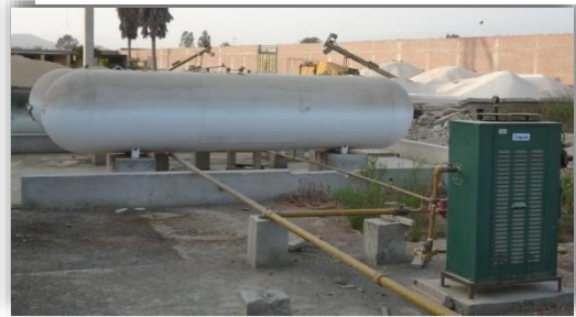
Figura 10.21: TANQUES DE GLP
