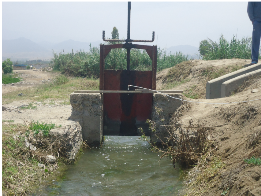
Figura 29: Compuerta tipo tarjeta. Fuente: Elaboración propia
