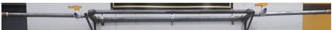
GRAFICO N° 4.27 LÍNEA DE PRUEBA N° 8 PARA TUBERÍA EN PARALELO DE ACERO GALVANIZADO DE \frac{1}{2} " DE DIÁMETRO
