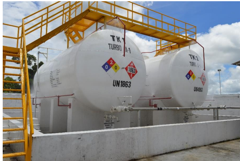
FIGURA 7: Zona de Almacenamiento de Combustible
