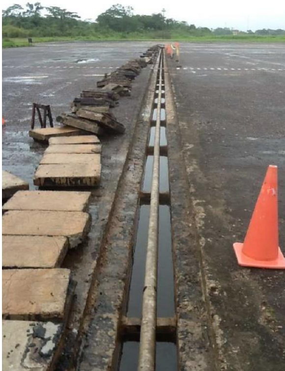
FIGURA N° 17: Línea de tubería hacia el punto de despacho (Pit hidrante)
