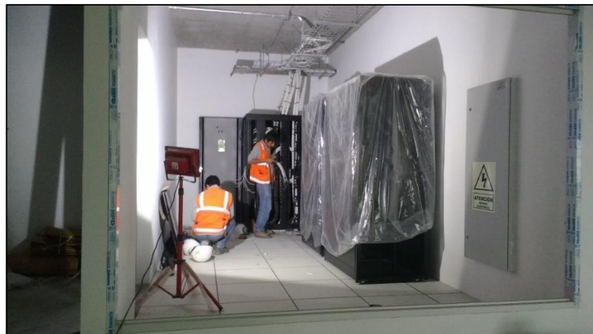
FIGURA N° 38. Tablero eléctrico para Data Center
