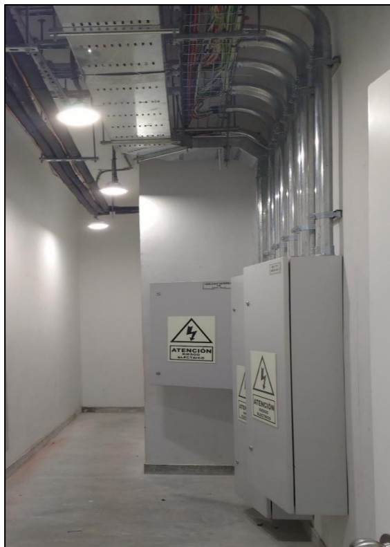
FIGURA N° 36. Tableros Eléctricos ubicados en el cuarto eléctrico
