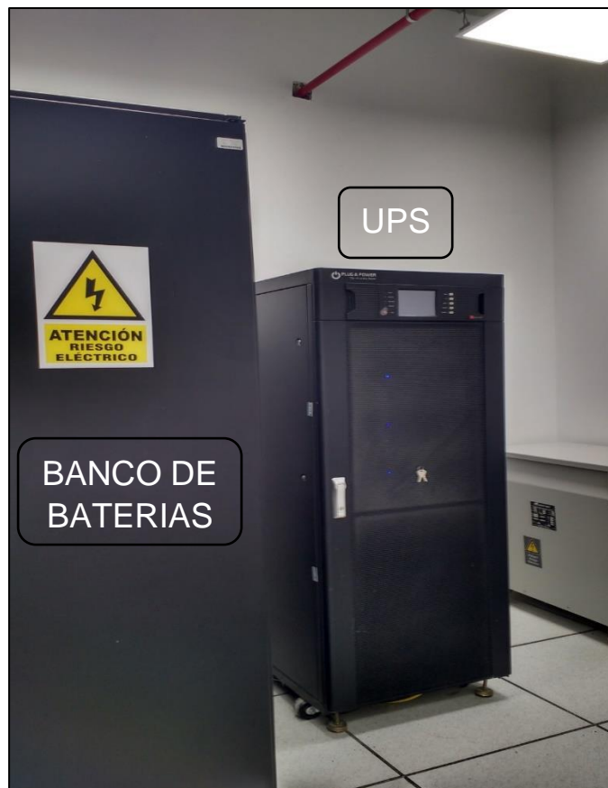
FIGURA N° 41. Banco de baterías, UPS, transformador
