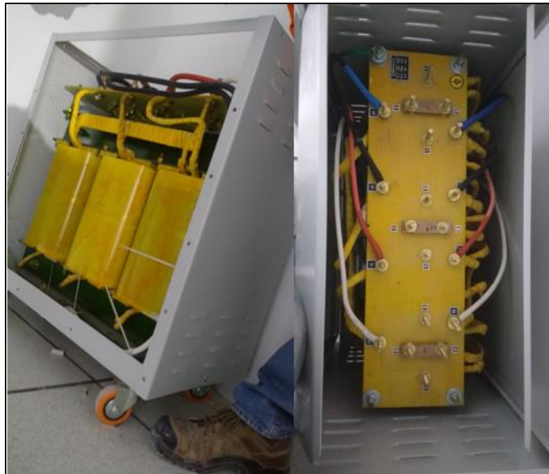
FIGURA N° 39. Transformador de 120 KVA
