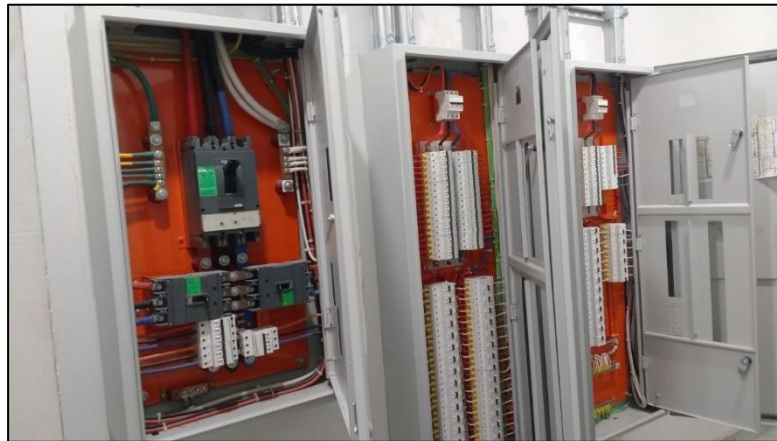
FIGURA N° 37. Tableros Eléctricos ubicados
