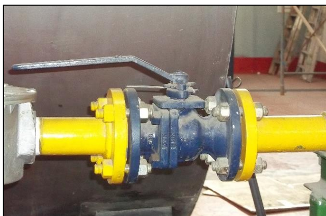
Figura 72: Válvula principal de gas natural aperturada
