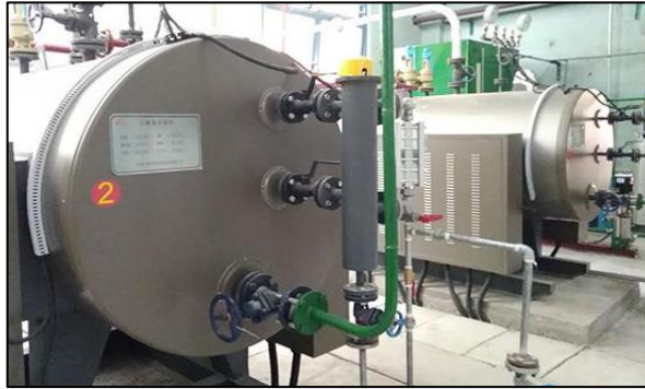
Figura 5: Caldera a resistencia eléctrica
