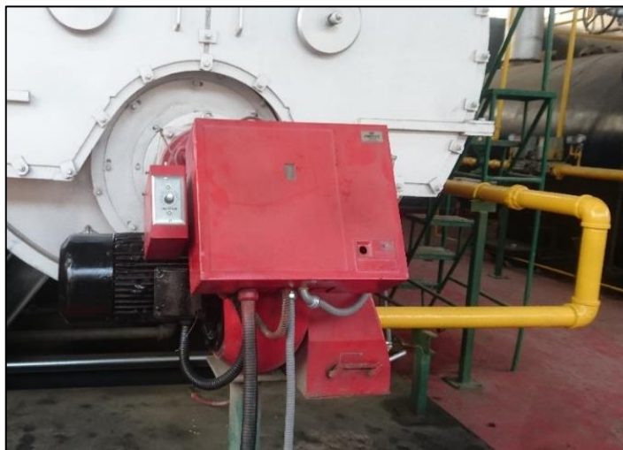
Figura 69: Quemador instalado en caldera Intensa de 400 BHP.
