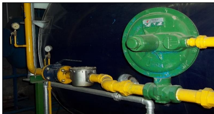
Figura 21: Estación de regulación secundaria
