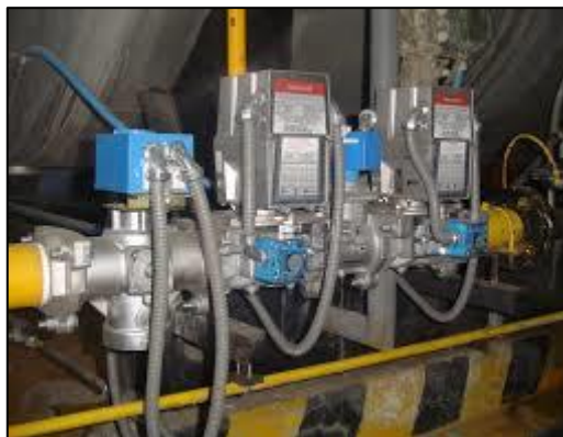
Figura 18: Tren de válvulas de combustión Equipos Térmicos
