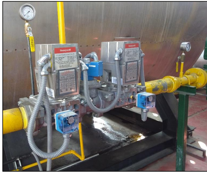
Figura 57: Tren de Gas Honeywell Instalado
