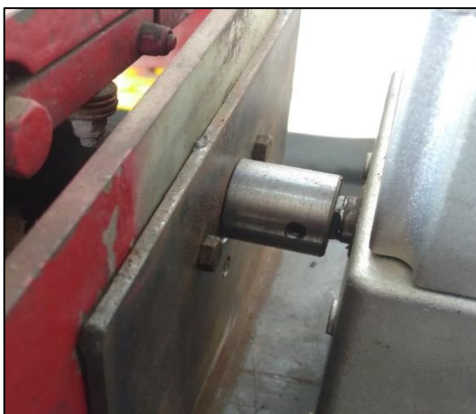
Figura 66: Eje Fabricado para adaptación de Motor modutrol
