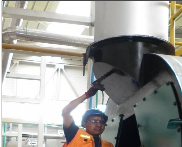
Figura 75: Análisis de gases en chimenea de la caldera
