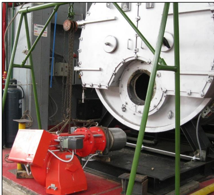
Figura 49: Desmontaje del quemador
