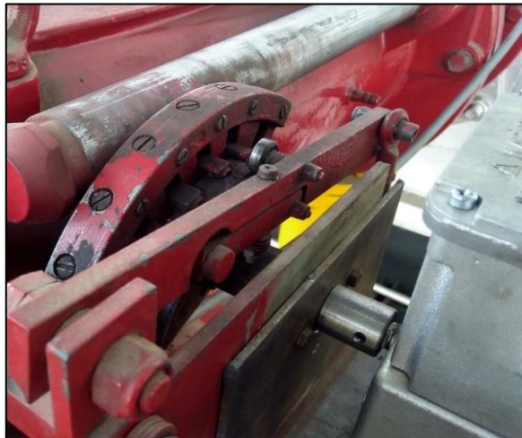
Figura 73: Prueba de apertura de clapeta de aire
