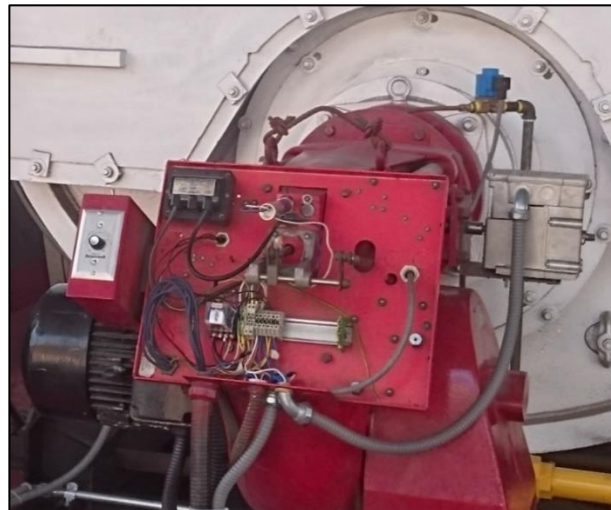
Figura 63: Fijación de fotocelda C7027 Honeywell al quemador.
