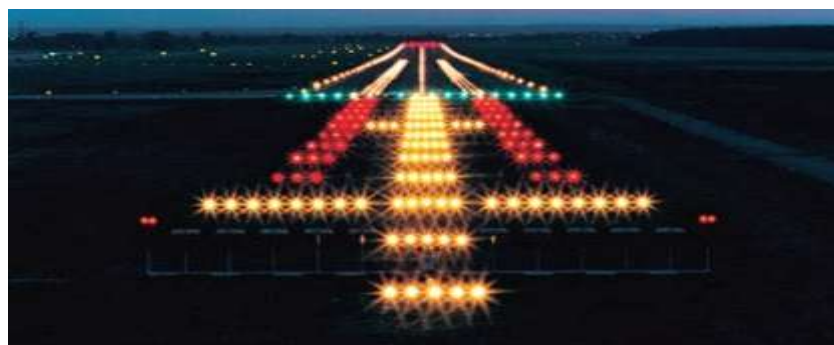
Figura N° 2.7. Imagen Sistema de Aproximación de Precisión CAT II Fuente Pagina especializada inglesa en tema Aeronáuticos https://www.aeros.co.uk/?attachment_id=4303
