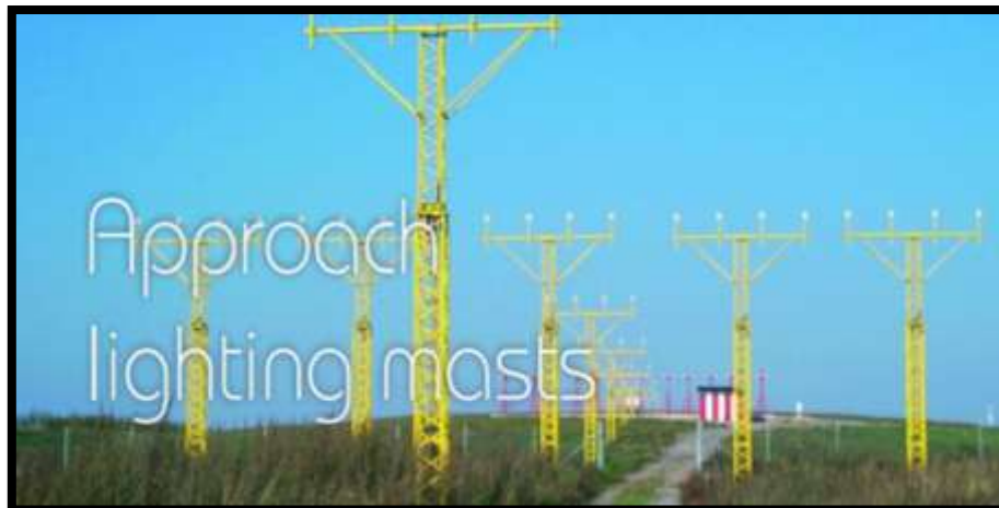
Figura N° 2.17. Estructuras Tipo Barretas Fuente: Empresa especializada en Airfield Ground Lighting – ADB Safegate
