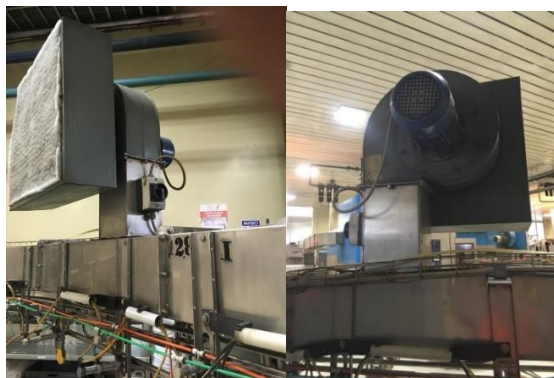
Figura N° 4.5 VENTILADOR CENTRIFUGO EXISTENTE
