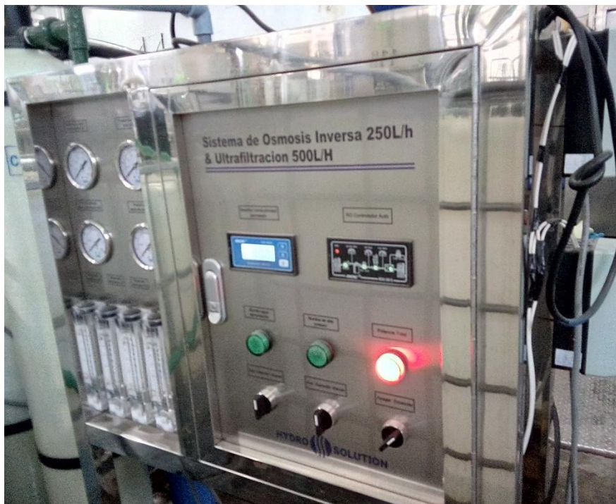
Figura 54. Sistema de ultrafiltración y ósmosis inversa
