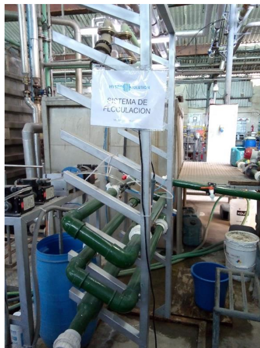
Figura 51. Sistema floculador de tubos
