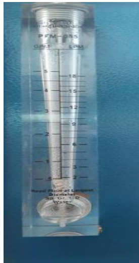
Figura 16. Rotámetro en módulo de oxidación avanzada
