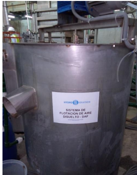
Figura 52. Tanque de floculación por aire disuelto (DAF)
