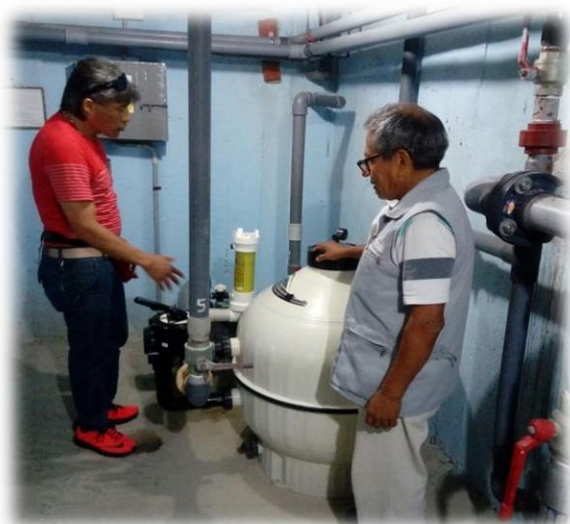
Figura 21. Inspector sanitario del c.s. san miguel supervisando los filtros y bombas del sistema de recirculación.
