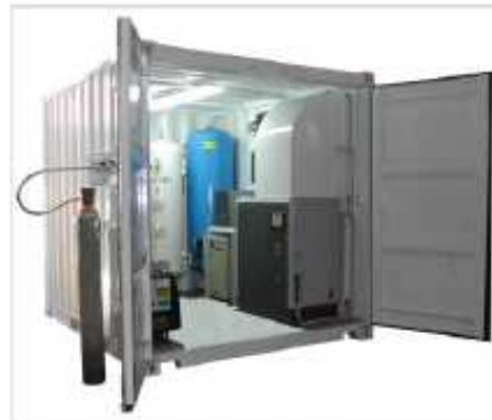
Contenedores con sistema de llenado de cilindros
