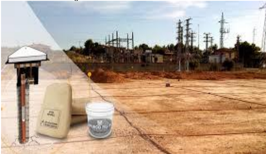
Figura 2. 38 Sistema de Puesta a Tierra
