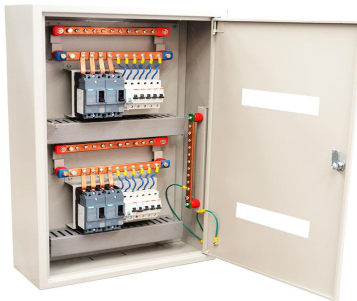
Figura 2. 29 Tablero Eléctrico Baja tensión
