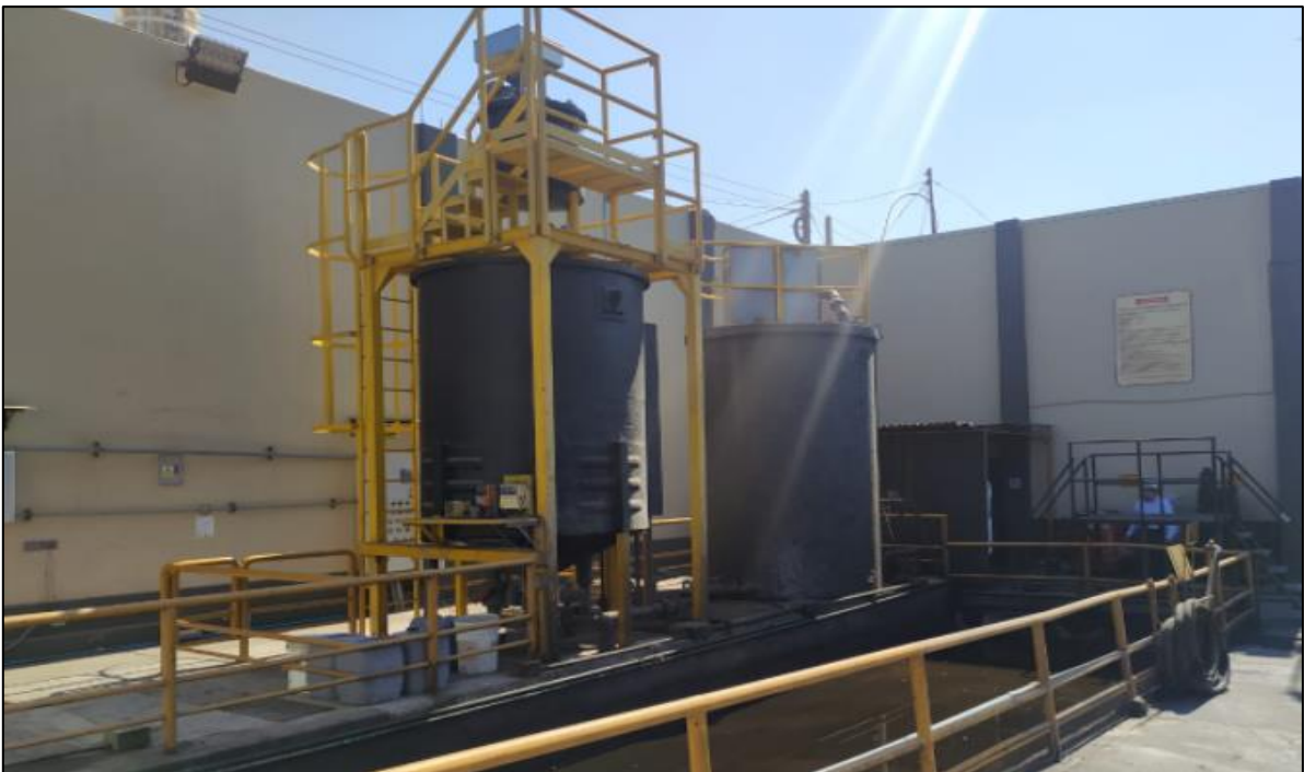
Planta de tratamiento de aguas residuales industriales
