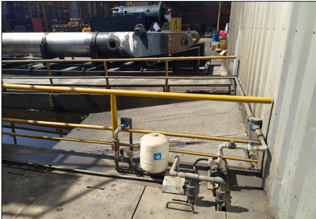
Sistema de Bombeo de agua tratada
