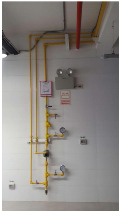
FIGURA 4.24 ESTACIÓN DE REGULACIÓN SECUNDARIA DE COCINA
