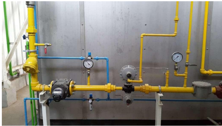
FIGURA 4.21 ESTACIÓN DE REGULACIÓN SECUNDARIA DE CALDERA
