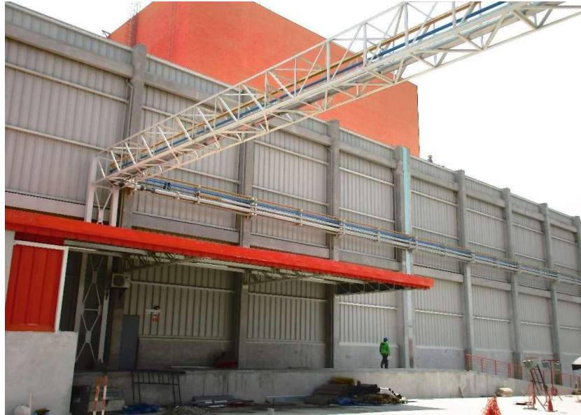
FIGURA 4.20 RACK DE TUBERÍAS EJE 10 Y HACIA CALDERA
