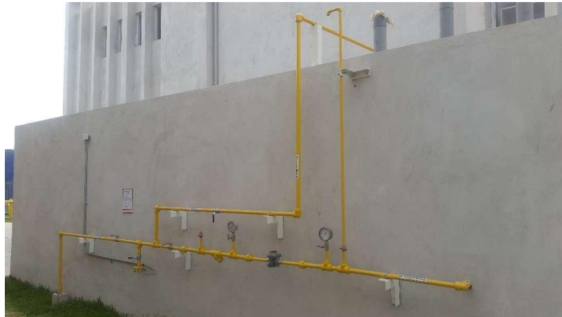
FIGURA 4.23 ESTACIÓN DE REGULACIÓN SECUNDARIA DE CALENTADORES
