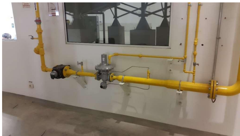
FIGURA 4.22 ESTACIÓN DE REGULACIÓN SECUNDARIA DE SECADOR
