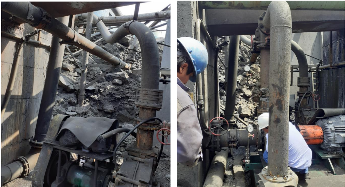
Figura N° 86 Fotos de Inspección de Bombas centrifugas
