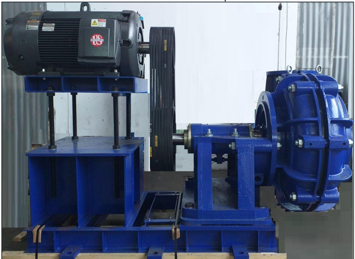
Figura N° 95 Bombas de alimentación a filtro prensa
