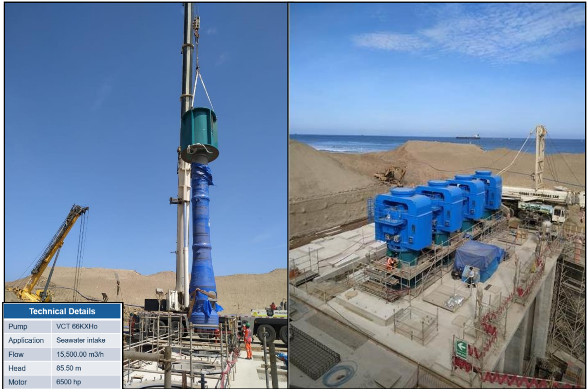
Figura N° 8. Proyecto Talara (Bombas Verticales Captación Agua de Mar)
