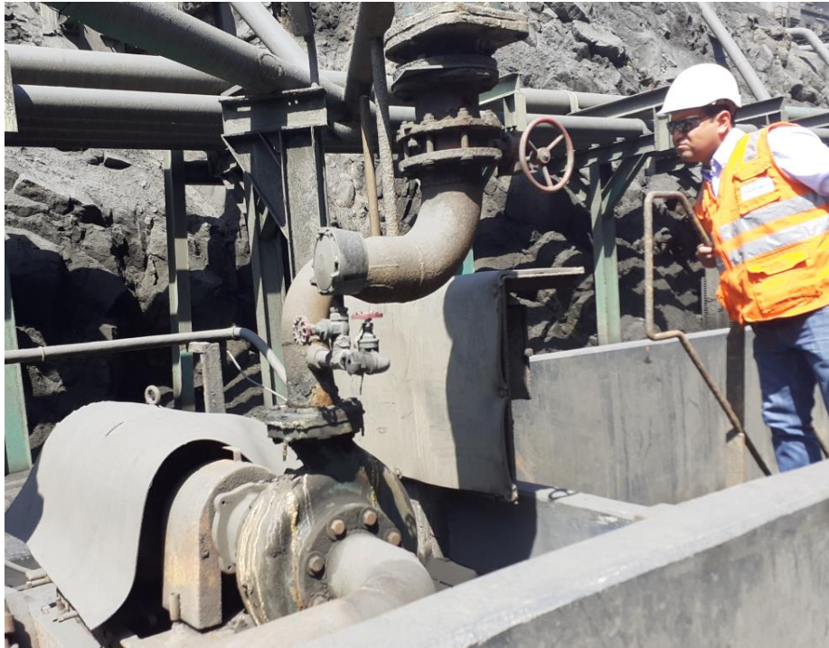
Figura N° 85 Fotos de Inspección de Bombas centrifugas
