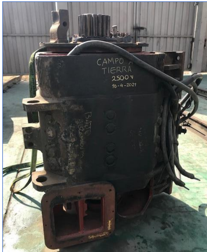
Figura 3.22: Motor de tracción con campo a tierra
