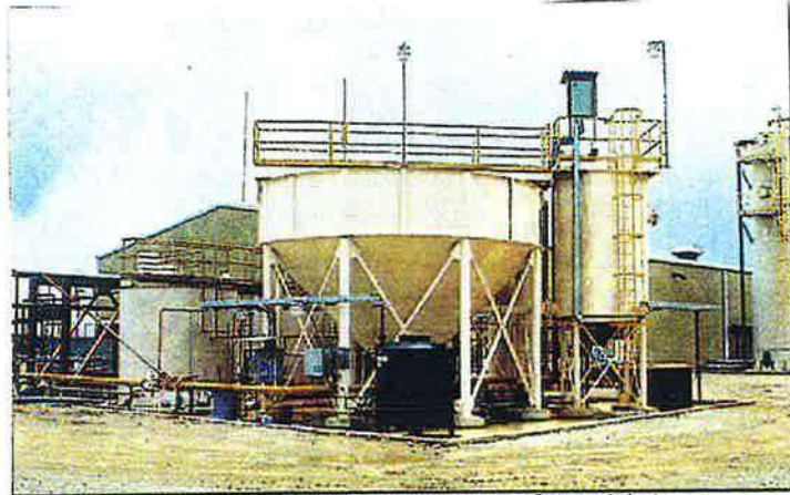
Vista exterior de la planta de tratamiento en Sipán. Admite un flujo de 500 metros cúbicos de solución rica por hora
