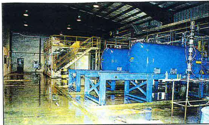
Tanques clarificadores, parte del proceso «Merril Crowe» en el circuito de obtención del oro
