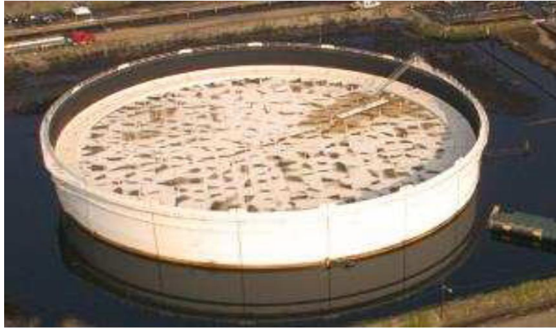
Figura 14. Tanque con techo flotante.
