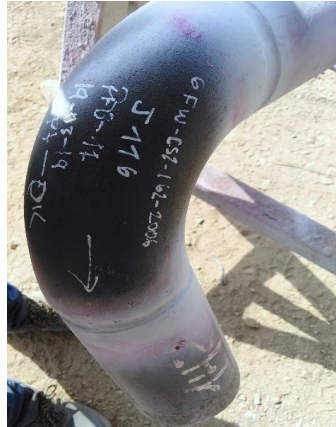
Figura 52. Tubería perteneciente al techo del tanque.
