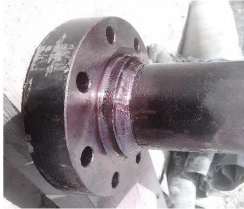
Figura 53. Brida perteneciente al techo del tanque.
