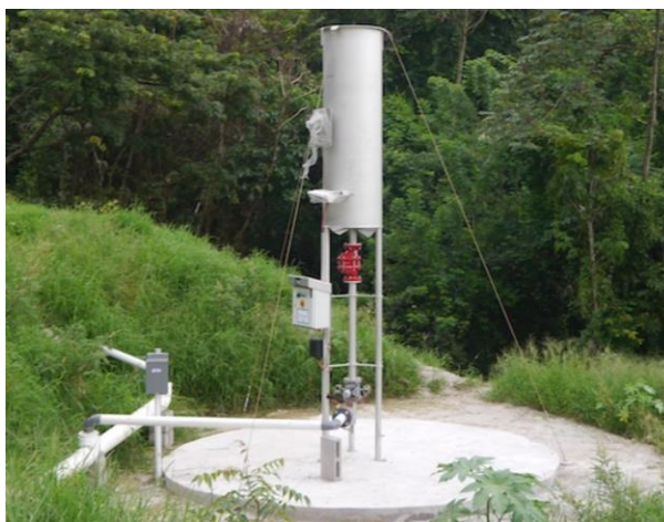
Figura 50. Caso de quemador abierto instalado. Fuente: empresa Aqualimpia
