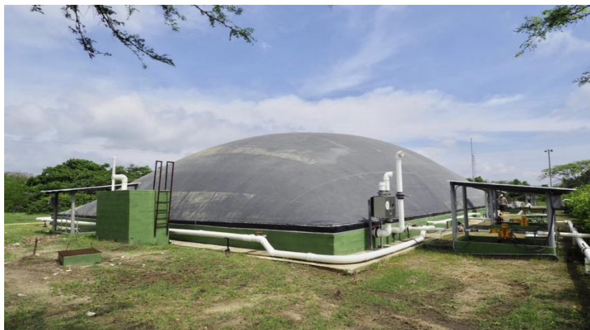
Figura 13. Biodigestor tipo laguna cubierta.
