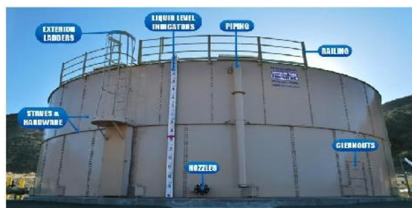
Figura N°5 Tanque de almacenamiento emperrado
