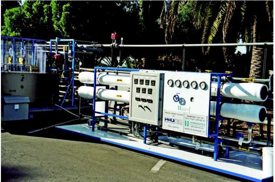
FIGURA 2. 12 EQUIPO DE OSMOSIS INVERSA
