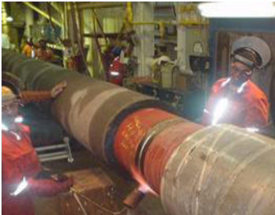
Fig. N° 8 Uniones soldadas de ductos dentro de la barcaza Fuente: Control de calidad de uniones soldadas – Jose Nevado Yenque
