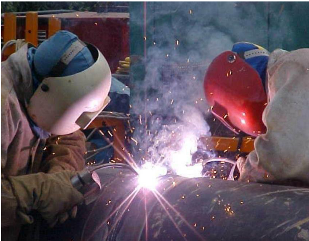
Fig. N° 1 Uniones soldadas de ductos
