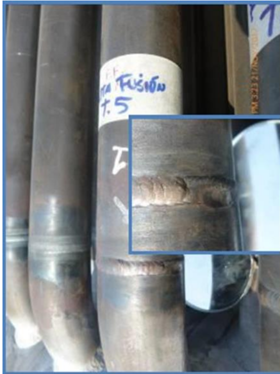
Figura 3.7: Falta de fusión en la unión del niple inferior y el tubo N°5 de la fila 3
