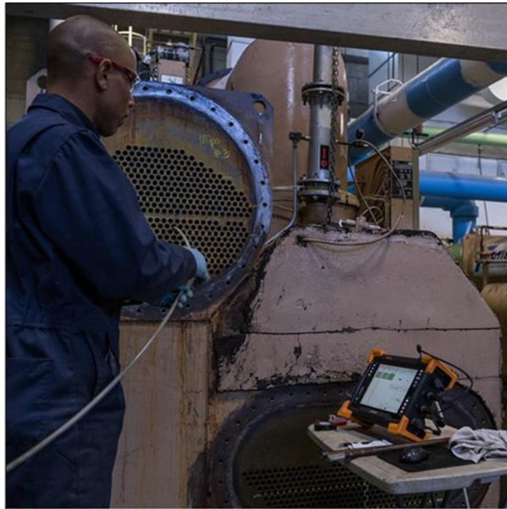
Figura 2.26: Inspección de tubos de un intercambiador de calor con corrientes inducidas.
