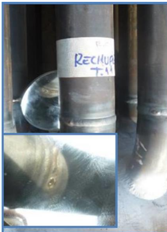
Figura 3.8: Rechupe en unión del niple inferior y el tubo N°11 de la fila 3
