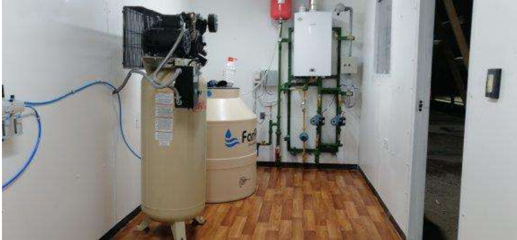
Figura 3.26: Parte interna de SALA DE CONTROL
