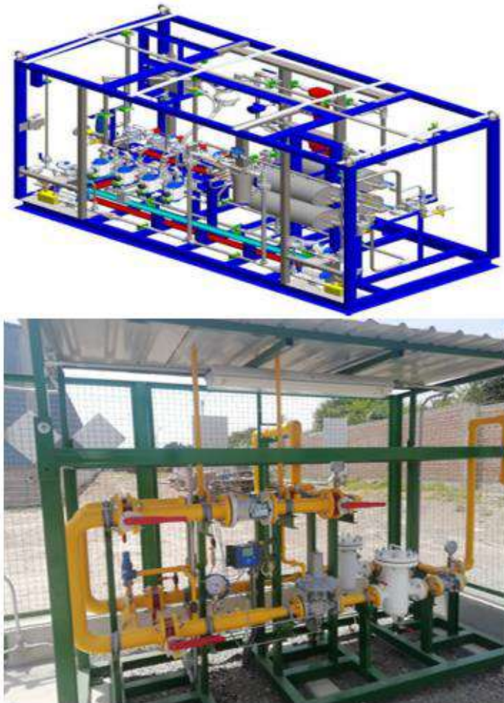
Figura 2.13: Unidad de descompresión (arriba) y estación de regulación de presión y medición – ERPM (abajo), utilizado para el sector industrial
