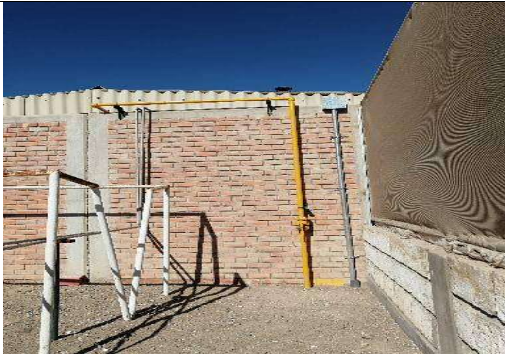
Fig. 06. Ingreso de tuberías a zona de calderos y parte electrica
