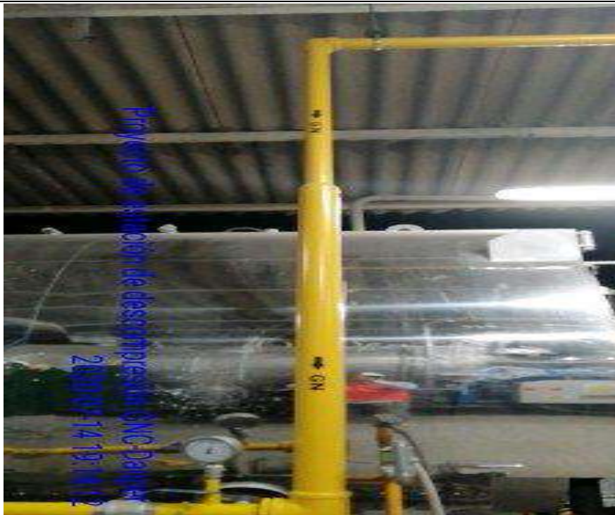
Fig. 05. Trabajo concluido llegada a calderos
