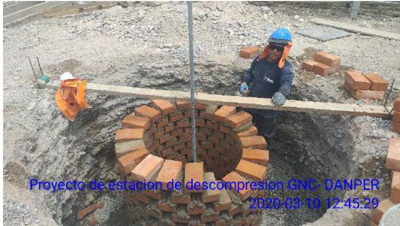
Figura 3.11: Pozo percolador del proyecto
