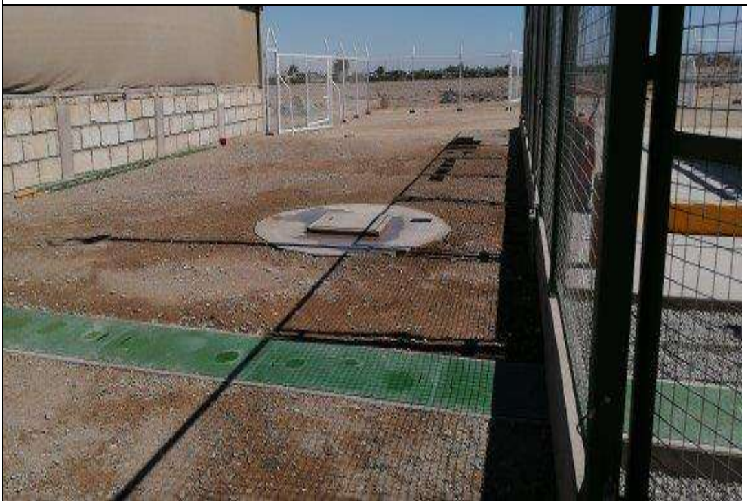
Fig. 10. Instalación en funcionamiento y perímetro limpio.
