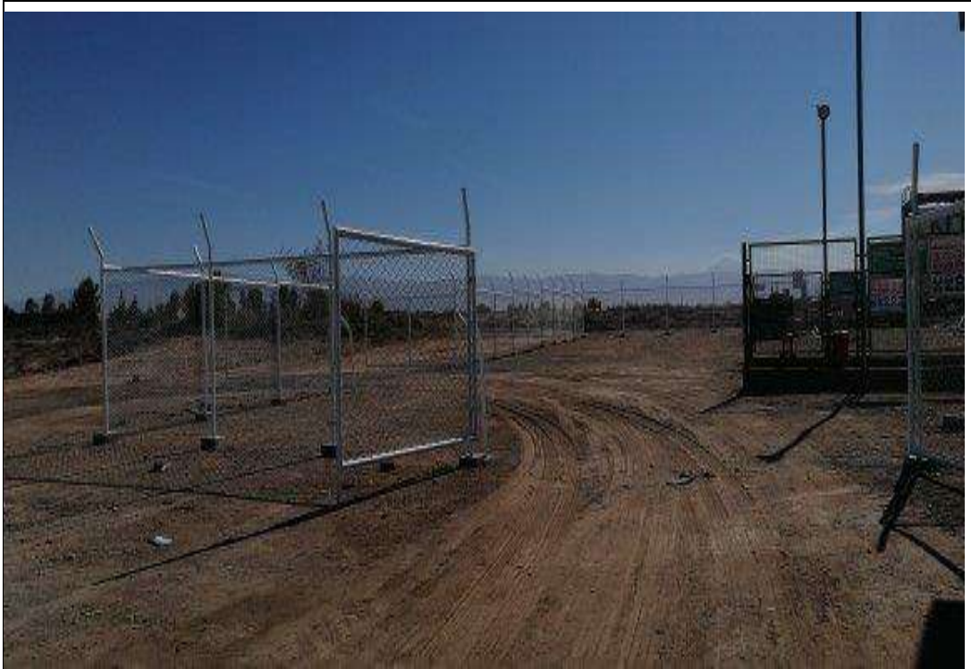
Fig. 09. Zona ingreso a estación de descompresión GNC.
