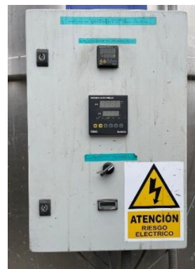
Foto 10: Tablero controlador de temperatura.
