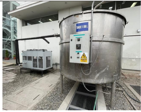
Foto 8: Tanque de enfriamiento de 8000L.
