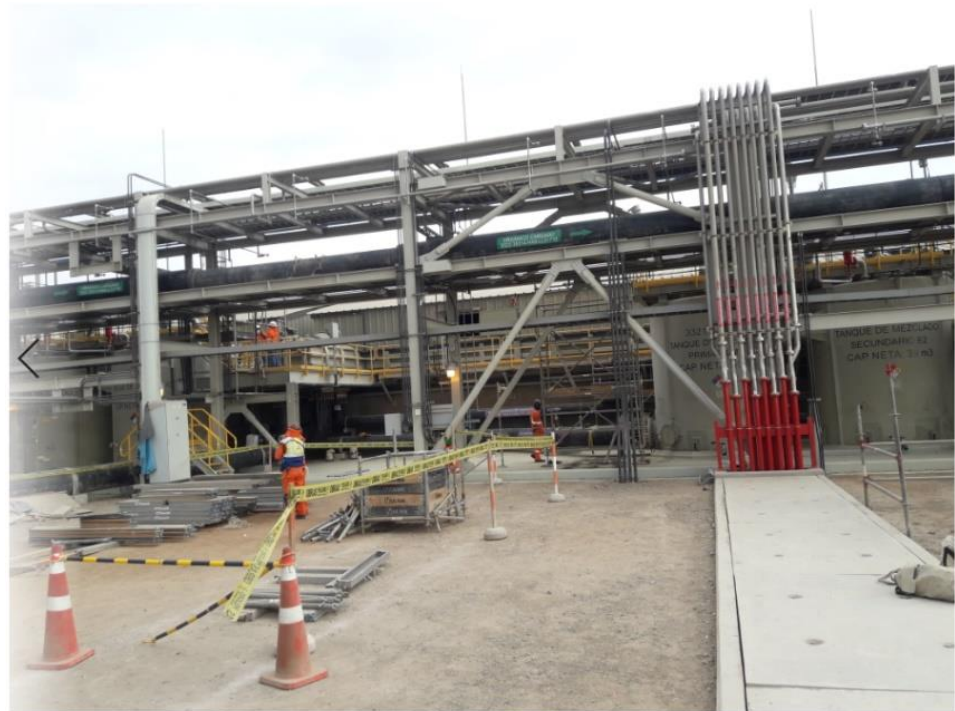
Figura 3.15 Pipe racks zona 1
