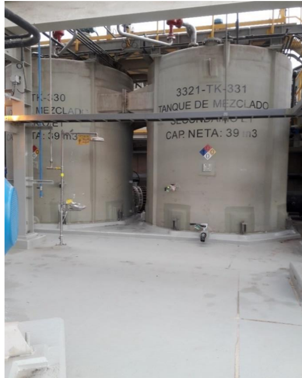
Figura 3.24 Cámaras de espuma en tanque de FRP mezclador
