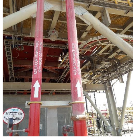
Figura 2.2 Sistema de tuberías contra incendio en Zaranda.
