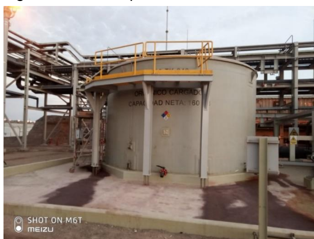
Figura 2.11 Tanque de almacenamiento de orgánico
