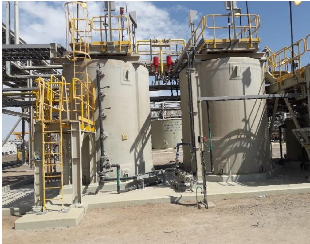
Figura 3.25 Cámaras de espuma en tanque de FRP de crudo
