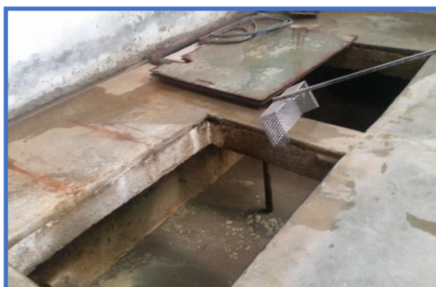
Poza de recepción de efluentes
