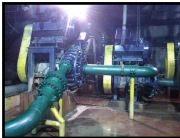
Figura N° 48 Bomba estacionaria GIW LSA
