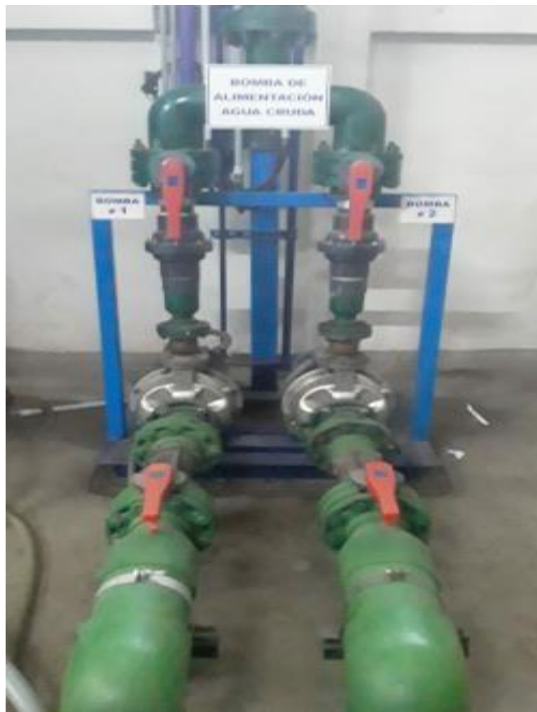
Bombas de alimentación de agua cruda
