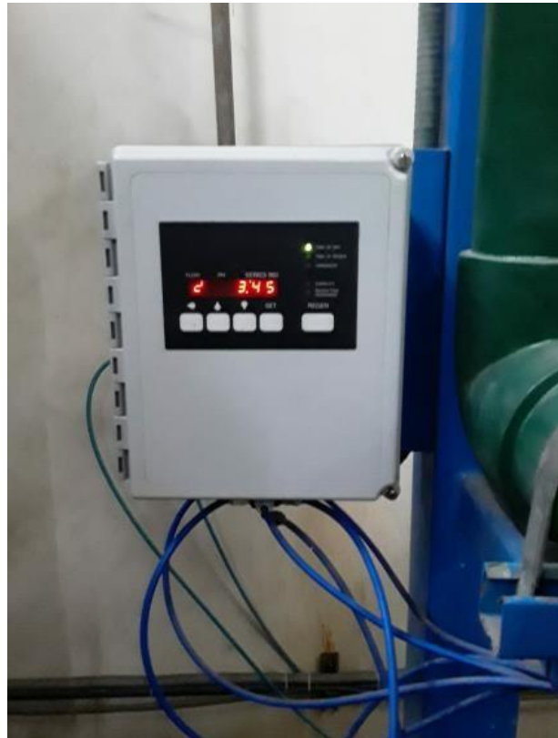
Panel de control del retro lavado
