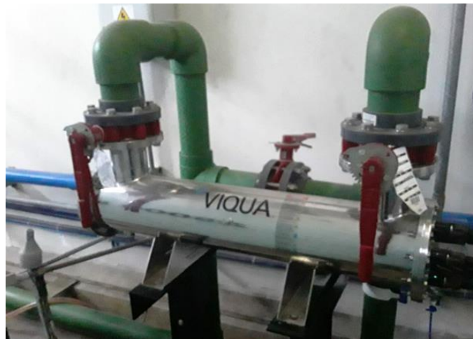
Equipo de filtración UV
