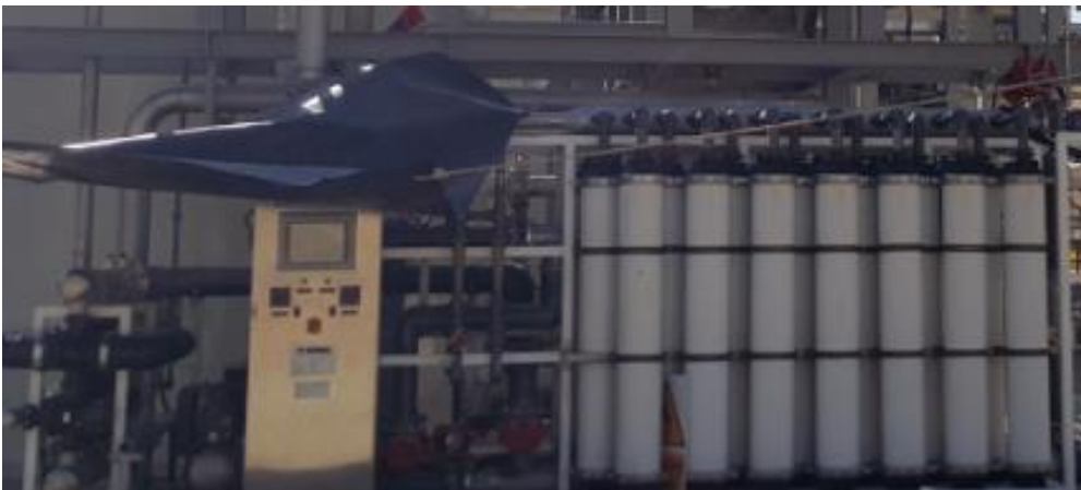
Figura N° 12 Sistema de Ultrafiltración
