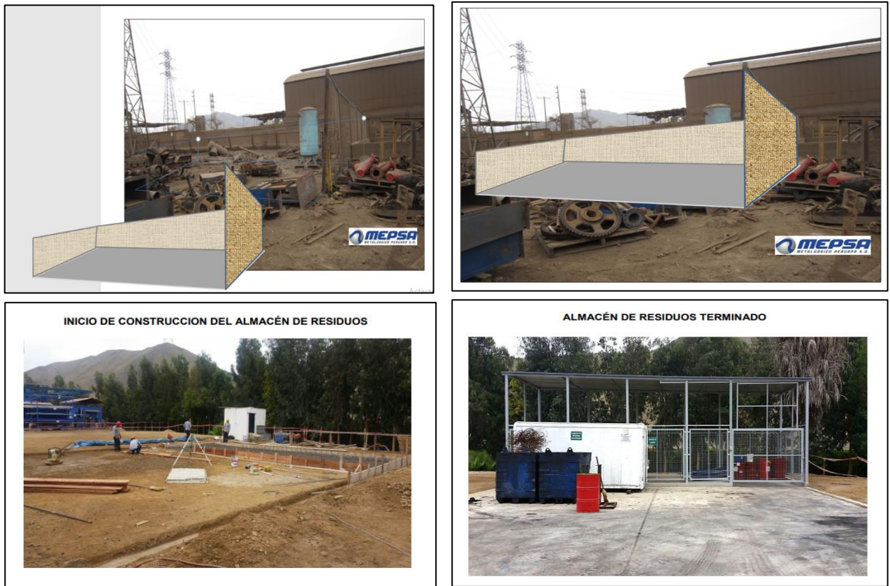
Figura 28. Fotografía del inicio y termino de construcción del almacén general de residuos sólidos, infraestructura perimetral y piso a base de polvillo metálico.
