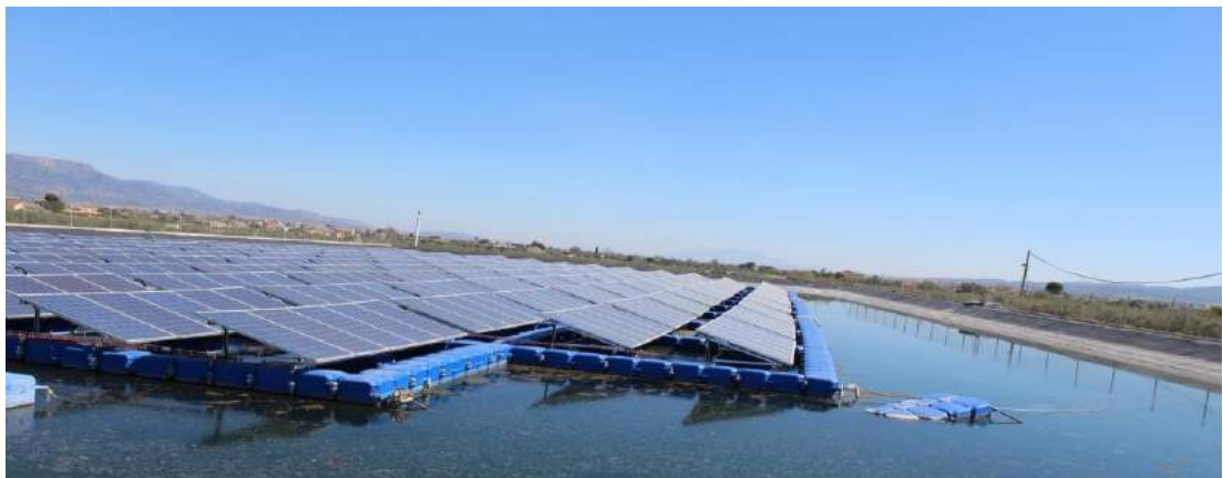
Figura 39 Fotografía de una instalación fotovoltaica flotante a cargo de Kaival S.A.C.
