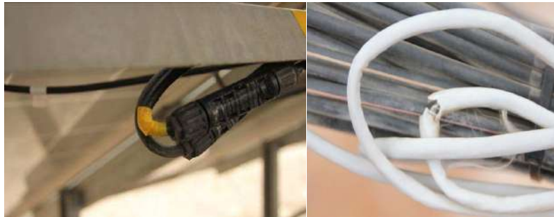
ILUSTRACIÓN 59 IZDA: INCOMPATIBILIDAD DE CONECTORES MC 4 (FUENTE: PI BERLIN AG); DCHA: FALTA DE IDONEIDAD PARA EXTERIOR DE LOS CABLES (FUENTE: PI BERLIN AG)
