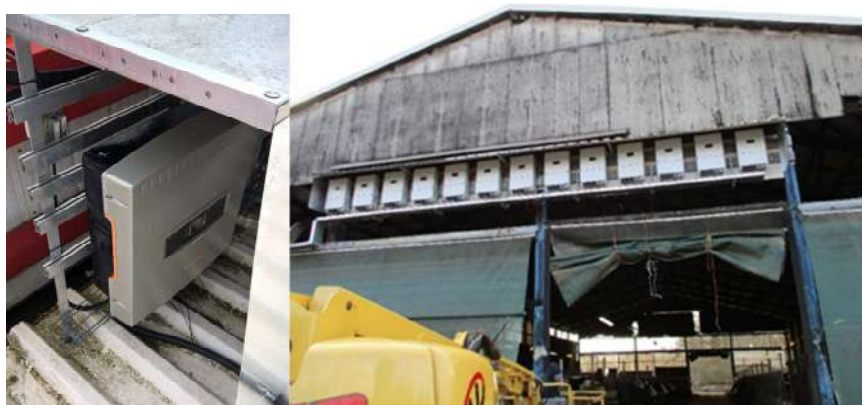
ILUSTRACIÓN 42 INVERSORES DIFÍCILMENTE ACCESIBLE PARA EL PERSONAL DE O&M (FUENTE: PI BERLÍN AG)
