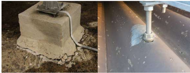
ILUSTRACIÓN 68 IZDA: PÉRDIDA DE ANCLAJE DE LA ZAPATA DE HORMIGÓN A LA SUPERFICIE DEL TEJADO (FUENTE: PI BERLÍN AG); DCHA: FALTA DE SELLADO DE LOS ORIFICIOS DE PENETRACIÓN (FUENTE: PI BERLÍN AG)
