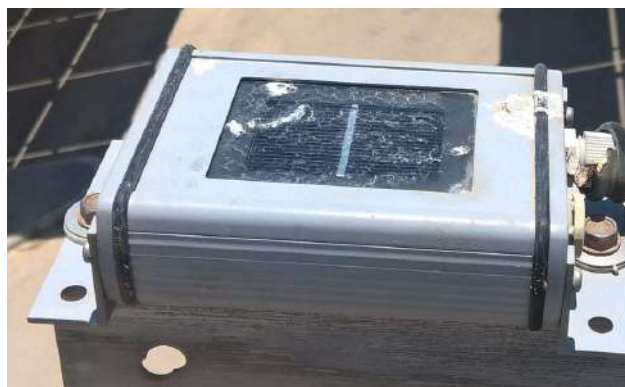
ILUSTRACIÓN 23 SENSOR DE RADIACIÓN CON SUCIEDAD, NO SE PUEDE DETECTAR EN LOS DATOS DE MONITOREO FÁCILMENTE.
