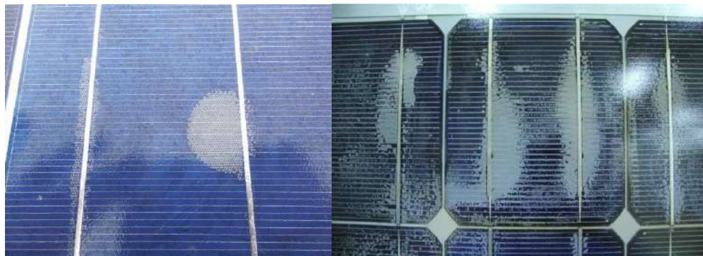
ILUSTRACIÓN 46 DELAMINACIÓN DEL MÓDULO (FUENTE: PI BERLÍN AG)
