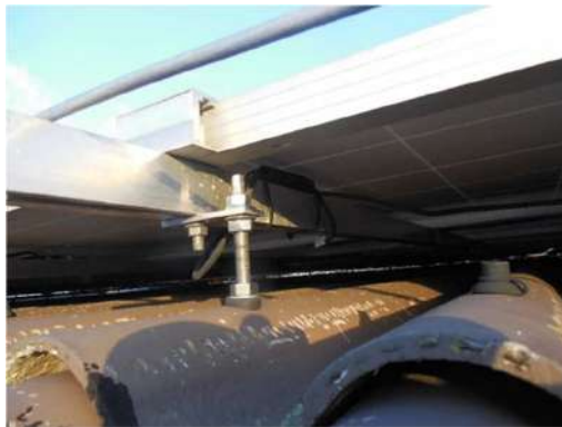
ILUSTRACIÓN 6 PLANTA FOTOVOLTAICA ANCLADA MEDIANTE PENETRACIÓN (FUENTE: PI BERLIN AG)
