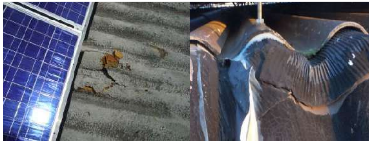
ILUSTRACIÓN 67 DAÑOS EN EL TEJADO POR TRÁNSITO DE PERSONAS (FUENTE: PI BERLÍN AG)
