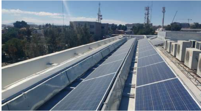
ILUSTRACIÓN 5 PLANTA FOTOVOLTAICA LASTRADA EN FISCALÍA DE CALAMA (FUENTE: MINISTERIO DE ENERGÍA)
