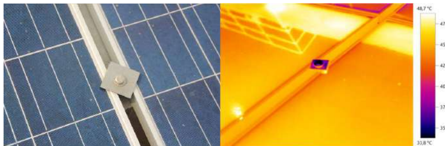
ILUSTRACIÓN 64 SUJECIÓN DE LOS MÓDULOS CON ABRAZADERAS INADECUADAS (FUENTE: PI BERLÍN AG)
