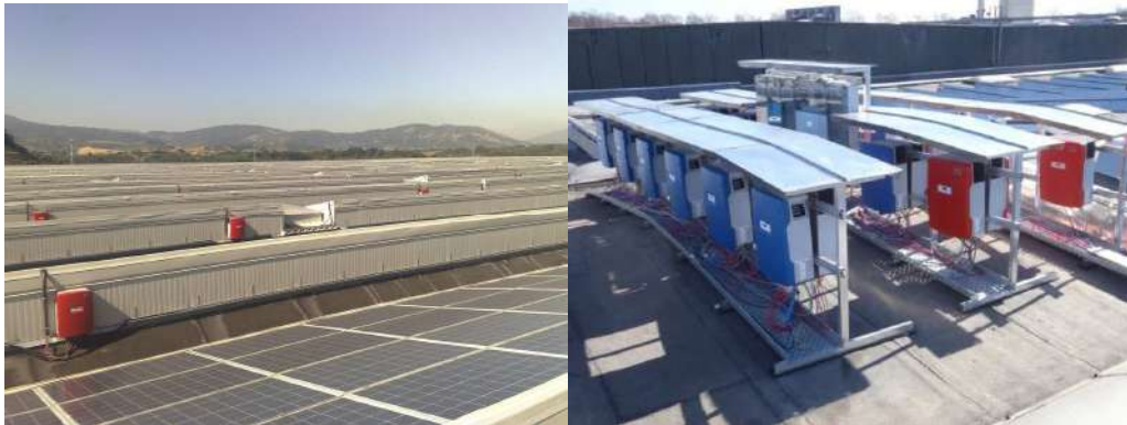
ILUSTRACIÓN 38 IZDA: INVERSORES DESPROTEGIDOS DEL EFECTO DE RADIACIÓN SOLAR DIRECTA (FUENTE: DGS BERLÍN E. V.); DRCHA: INVERSORES PROTEGIDOS DE LA RADIACIÓN SOLAR DIRECTA (FUENTE: PI BERLÍN AG)
