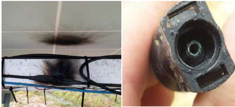
ILUSTRACIÓN 63 EXPLOSIÓN DE LOS CONECTORES POR CORROSIÓN EN LA CONEXIÓN (FUENTE: PI BERLÍN AG)
