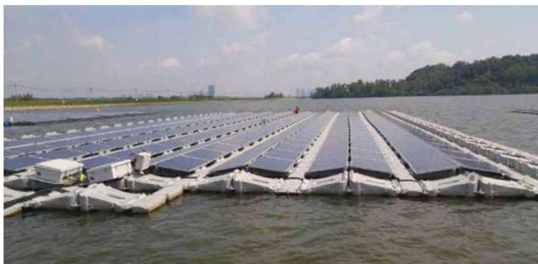
Figura 13 Fotografía de un sistema fotovoltaico flotante (FPV)
