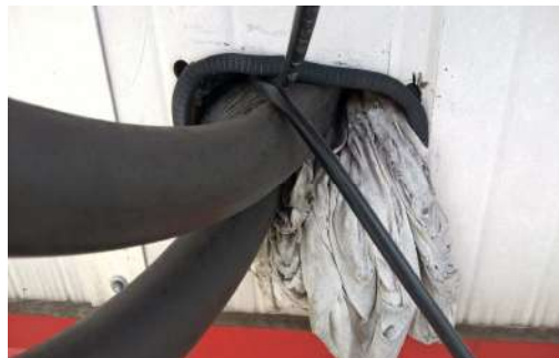
ILUSTRACIÓN 58 FALTA DE SELLADO DE LOS TUBOS DE ACOMETIDA (FUENTE: PI BERLIN AG)
