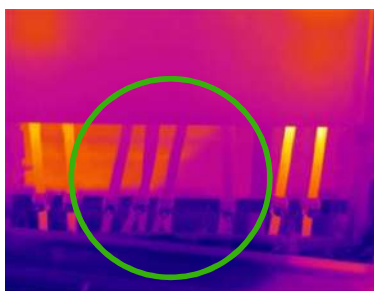
ILUSTRACIÓN 70 INTERRUPCIÓN DE LA CORRIENTE EN VARIOS STRINGS A LA ENTRADA DE LA CAJA DE COMBINACIÓN . FOTO REALIZADA CON UNA CÁMARA DE INFRARROJOS (FUENTE: PI BERLIN AG)
