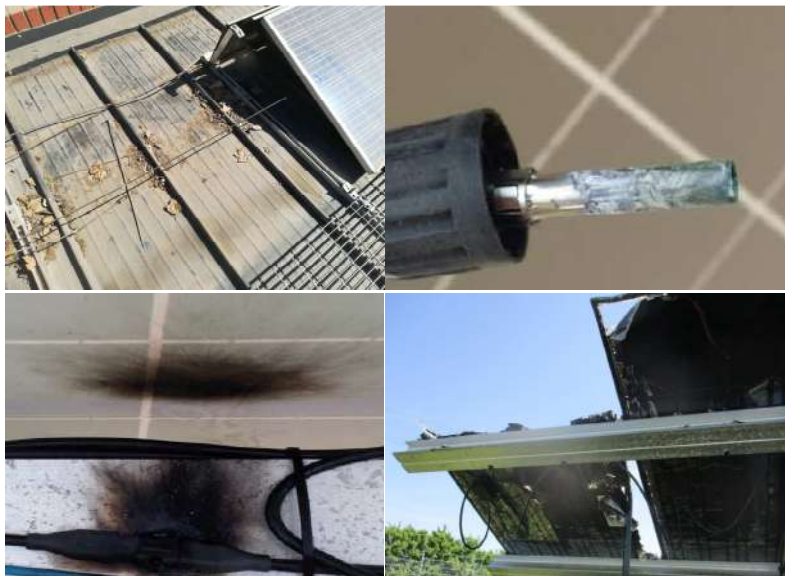
ILUSTRACIÓN 13 IZQ. ARRIBA: ACUMULACIÓN DE HOJAS SECAS EN LA PLANTA FOTOVOLTAICA. DER. ARRIBA: CONECTOR CORROÍDO. IZQ. ABAJO: EXPLOSIÓN EN CONECTOR POR ACUMULACIÓN DE POLVO; DER. ABAJO: PANEL FV INCENDIADO (FUENTE: PI BERLÍN AG)
