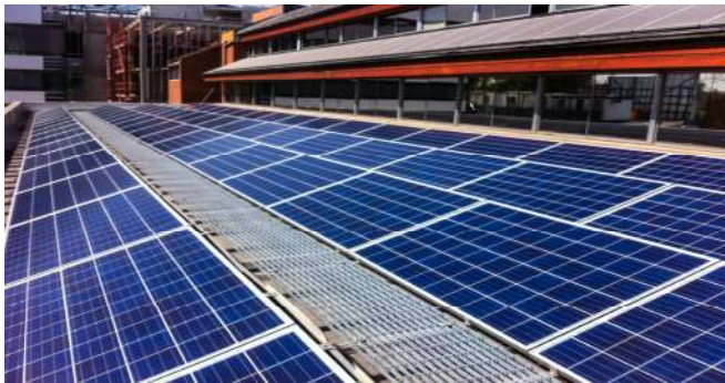
ILUSTRACIÓN 3 EJEMPLO MÓDULOS EN UN SFV, TELETÓN SANTIAGO (FUENTE: MINISTERIO DE ENERGÍA)
