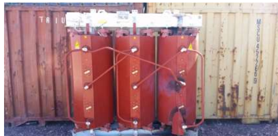
ILUSTRACIÓN 76 TRANSFORMADOR DE RESINA DAÑADO POR VENTILACIÓN INADECUADA Y ACUMULACIÓN DE POLVO (FUENTE: PI BERLIN AG)
