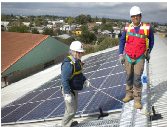
ILUSTRACIÓN 20 EJEMPLO DE MEDIDAS DE SEGURIDAD PARA PROTECCIÓN CONTRA CAÍDAS (FUENTE: MINISTERIO DE ENERGÍA)
