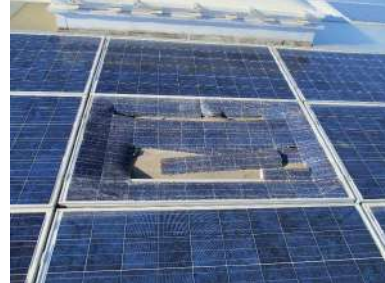
ILUSTRACIÓN 75 PANEL INTEGRADO EN TEJADO DAÑADO POR SOBRECALENTAMIENTO (FUENTE: PI BERLIN AG)
