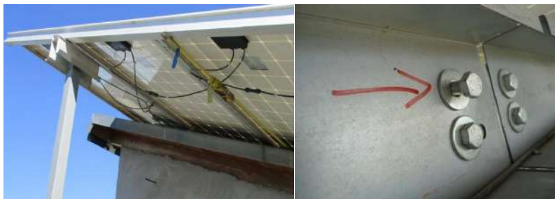
ILUSTRACIÓN 65 IZDA: SUJECIÓN DE LOS MÓDULOS A LA ESTRUCTURA DEL TEJADO CON CINTAS DE AMARRE (FUENTE: PI BERLÍN AG); DCHA: AFLOJAMIENTO DE LOS TORNILLOS DE SUJECIÓN DE LOS PERFILES TRANSVERSALES (FUENTE: PI BERLÍN AG)
