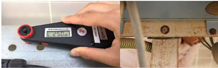
ILUSTRACIÓN 66 IZQ: MEDICIÓN DE LA CAPA DE GALVANIZADO DEL PERFIL TRANSVERSAL DE LA ESTRUCTURA DE SUJECIÓN DE LOS PANELES (FUENTE: PI BERLÍN AG); DER: OXIDACIÓN DE LA SUPERFICIE DE LA ESTRUCTURA DE SUJECIÓN DE LOS PANELES (FUENTE: PI BERLÍN AG)
