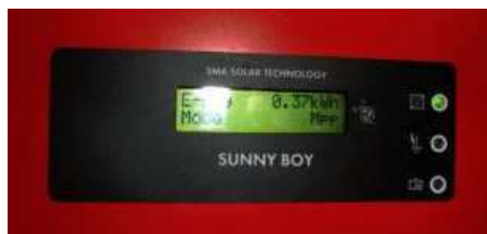
ILUSTRACIÓN 12 EJEMPLO DE UN INVERSOR INDICANDO BUEN FUNCIONAMIENTO, BAJO LA LUZ VERDE UNA LUZ ROJA INDICARÁ UNA FALLA A TIERRA.
