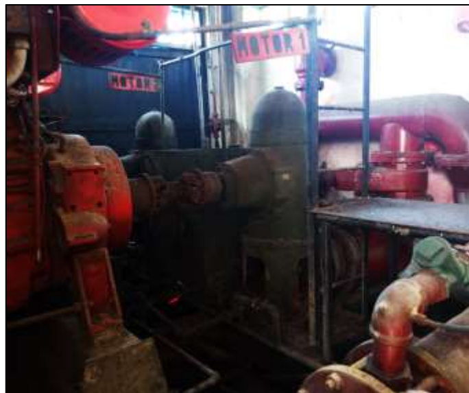
Figura 3.4 – Sistema contra incendio deteriorado
