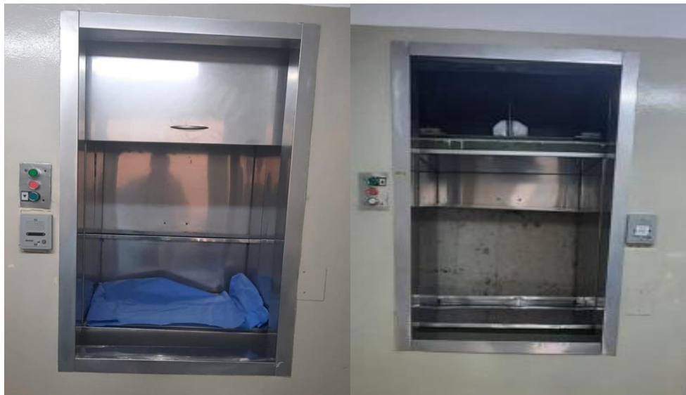
Figura 3.8 montacargas pabellón b – central de esterilización
