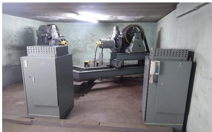
Figura 2.3: imagen del cuarto de maquinas
