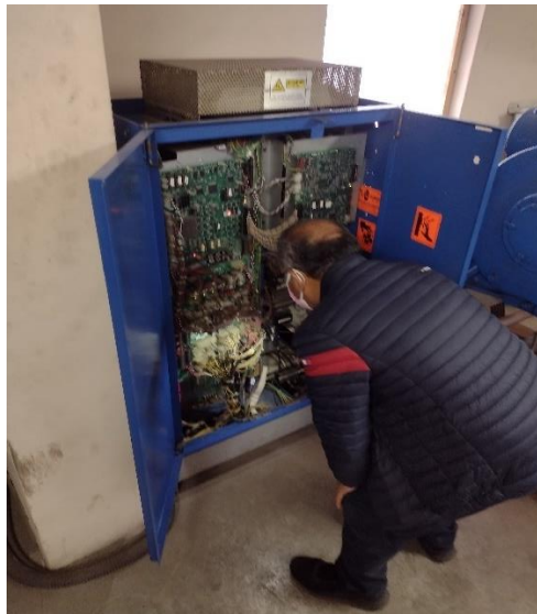
Figura 2.7: imagen del sistema de Control
