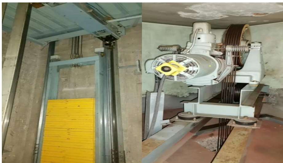
Figura 3.17: Revisión y ajuste de la tensión de los cables de tracción y las chavetas
