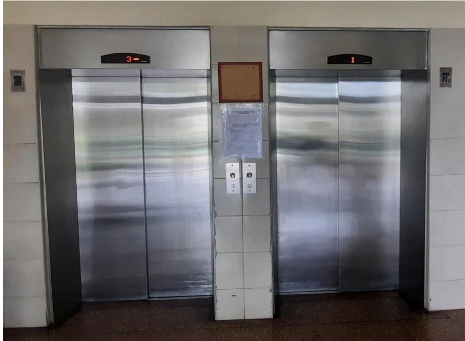
Figura 3.2 ascensores monta camillas Hyundai del pabellón A
