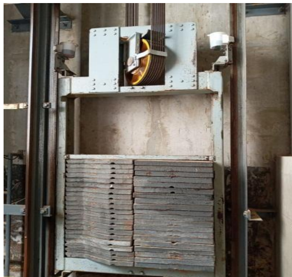
Figura 2.4: imagen del Contrapeso del ascensor
