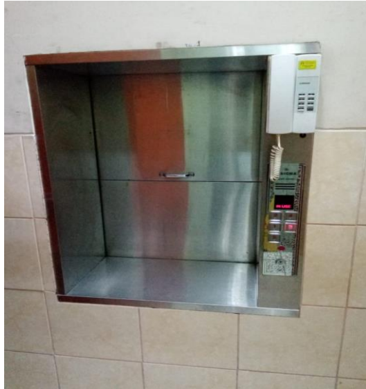
Figura 3.7 montacargas del Cetide
