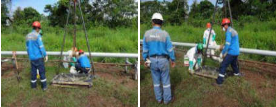
Fotografía N° 1 – 2 Activación de la brigada contra derrames.
