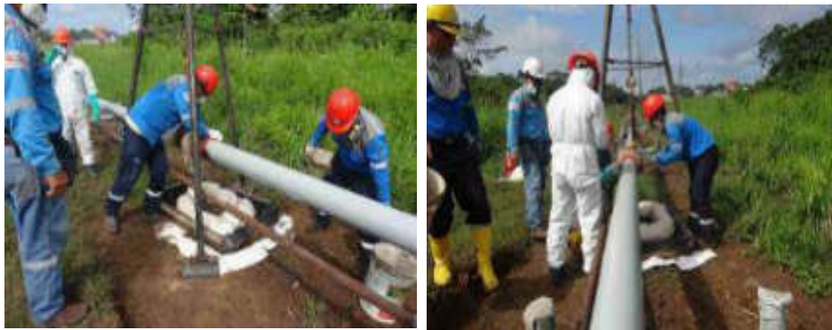
Fotografía N° 3 – 4 Activación de la brigada contra derrames.
