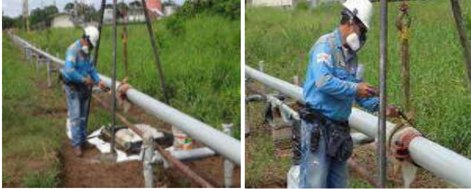
Fotografía N° 7-8: Monitoreo de % LEL en punto de fisura.
