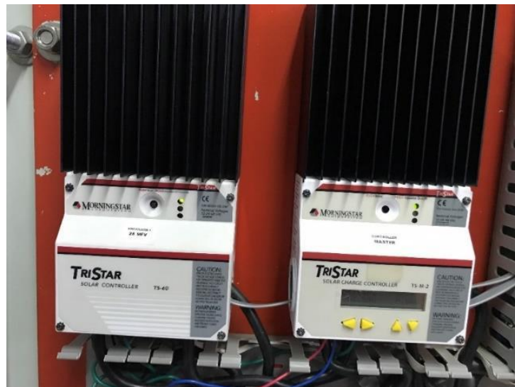
Figura N° 20: Controladores de carga del tablero TCP2
