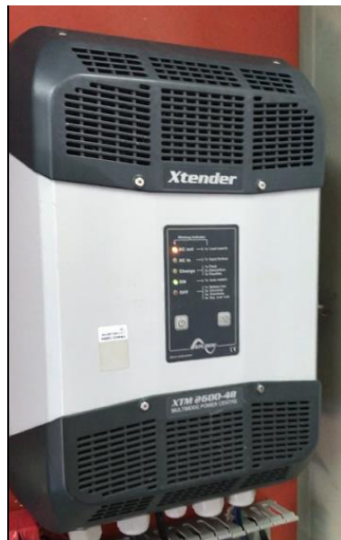
Figura N° 21: Inversor/cargador Xtender XTM 2600-48 del Tablero TCP1
