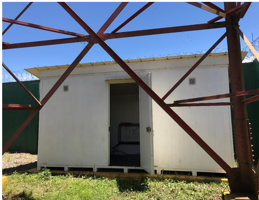
Figura N° 18: Shelter de almacenamiento de energía.
