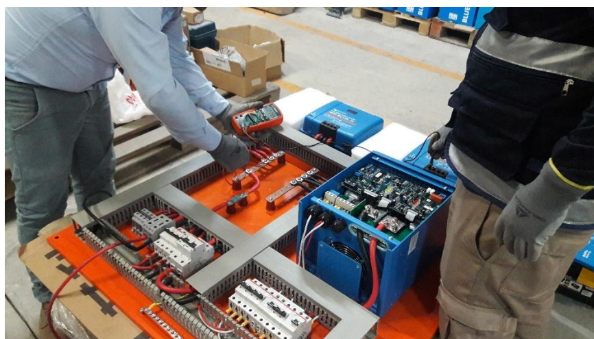
Figura N° 27: Ensamblaje y Pruebas de Tableros en el Almacén de Engie
