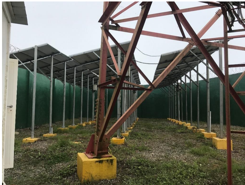
Figura N° 19: Unidad de generación – 120 módulos fotovoltaicos de 85 Wp
