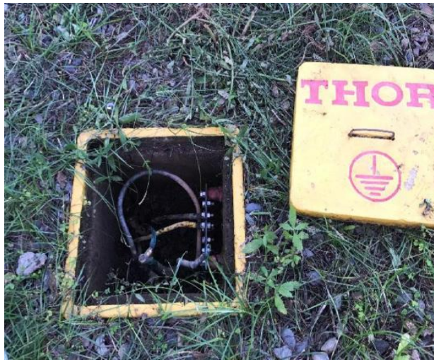
Figura N° 25: Caja de Registro del sistema de puesta a tierra.
