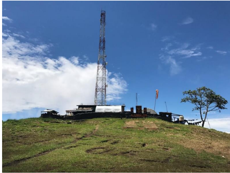
Figura N° 17: Antena de comunicaciones Cerro Peladilla - Kiteni
