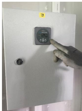
Figura N° 40: Monitor de baterías en el tablero TCM
