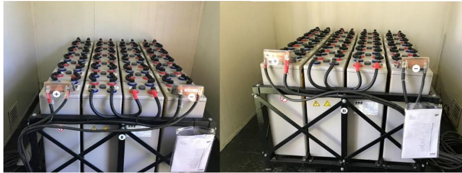
Figura N° 22: Sistema de almacenamiento de Energía
