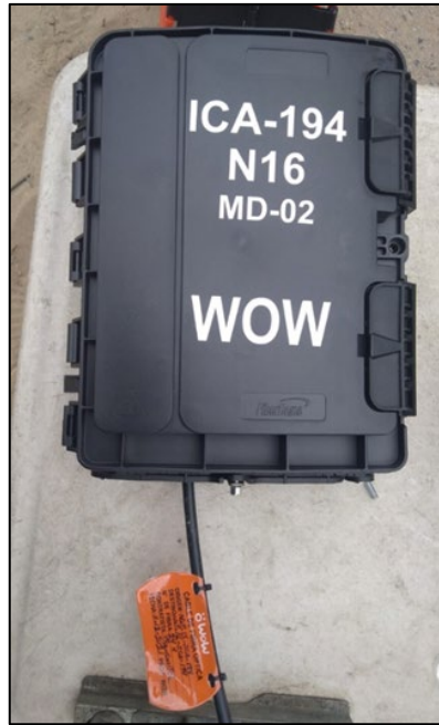
Fig. N.º 65: “Parte externa de Caja NAP con rotulado para identificación”
