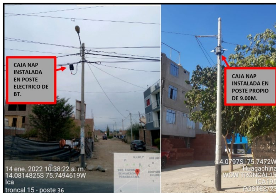
Fig. N.º 32: “Poste ELECTRODUNAS de baja tensión, se encuentra apto para realizar tendido e instalación de equipos”
