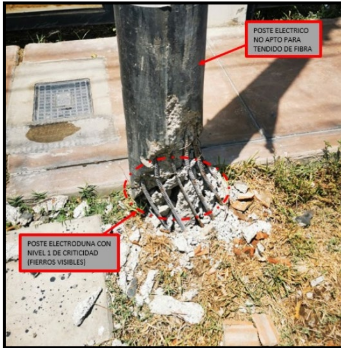
Fig. N.º 24: “Fotografía de un poste con base en mal estado, nivel I de criticidad”
