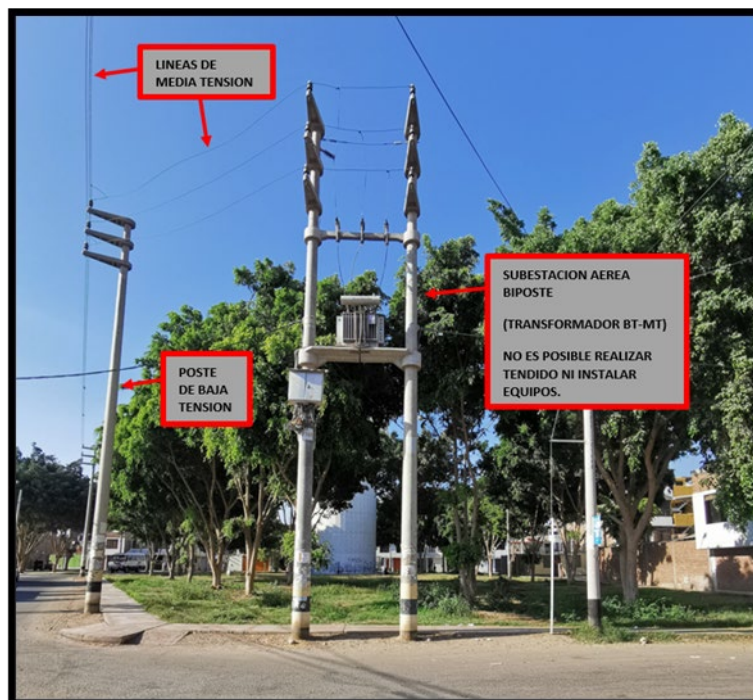
Fig. N.º 47: “Transformador MT a BT o subestación aérea Biposte, la cual no se puede utilizar como punto de apoyo”
