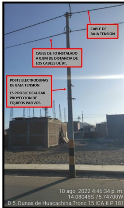
Fig. N.º 29: “Poste ELECTRODUNAS de baja tensión, se encuentra apto para realizar tendido e instalación de equipos”
