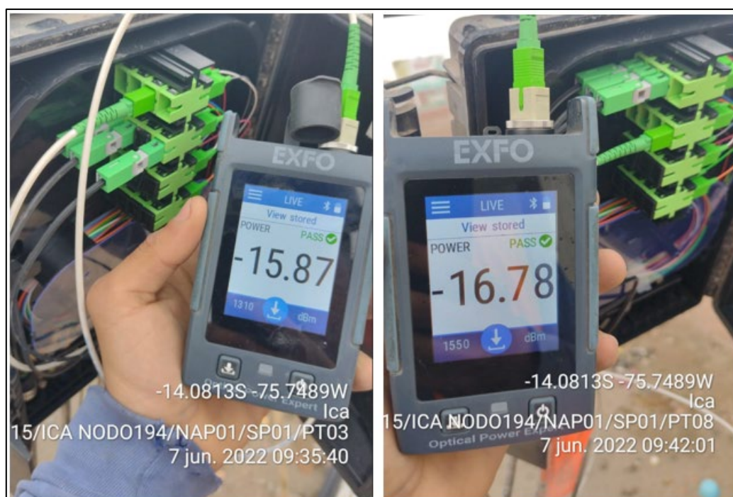
Fig. N.º 83: “Prueba de potencia en ventana 1310 nm y 1550 nm realizada en la NAP 01, CLÚSTER ICA_194, puertos 07 y 08”
