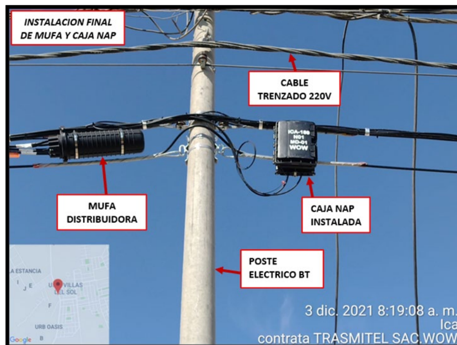
Fig. N.º 69: “Instalación de caja NAP junto a Mufa de distribución en poste eléctrico”
