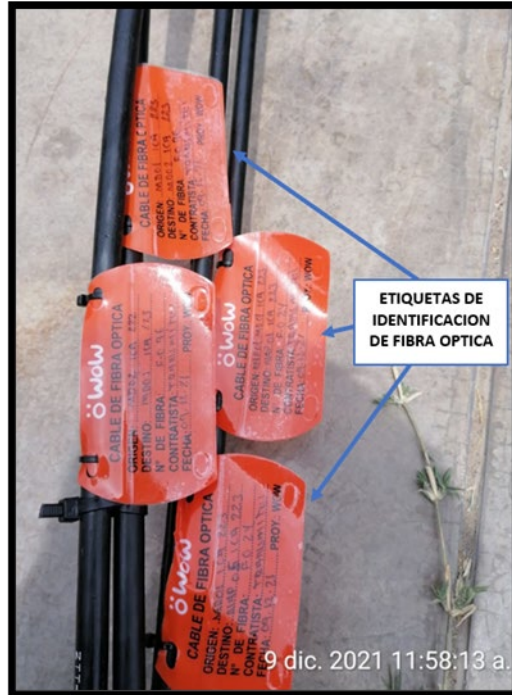
Fig. N.º 58: "Etiquetado de cables de fibra óptica para su posterior reconocimiento por el equipo de mantenimiento preventivo / correctivo"
