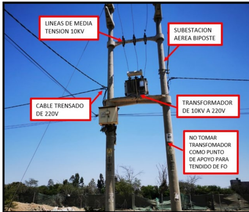
Fig. N.º 31: “Subestación Aérea Biposte (SAB), en la cual no se puede realizar tendido ni proyección de equipos”
