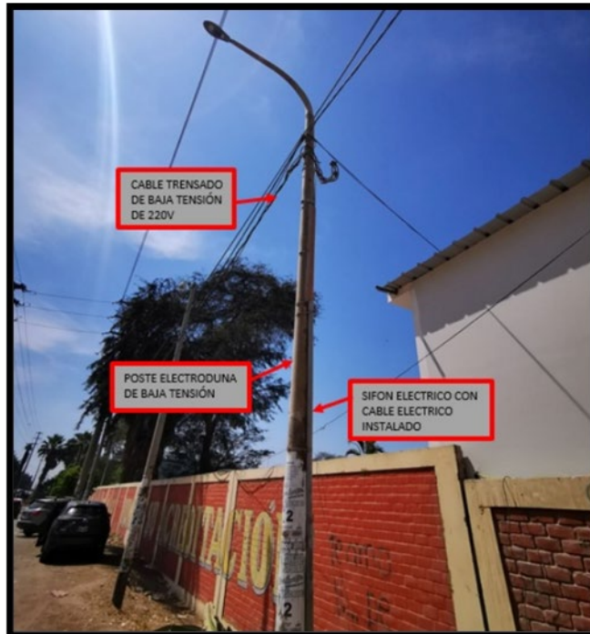
Fig. N.º 46: “Poste Electroquinas de baja tensión con presencia de sifón eléctrico, por el cual no es posible realizar proyección de equipos ni cableado de fibra óptica”
