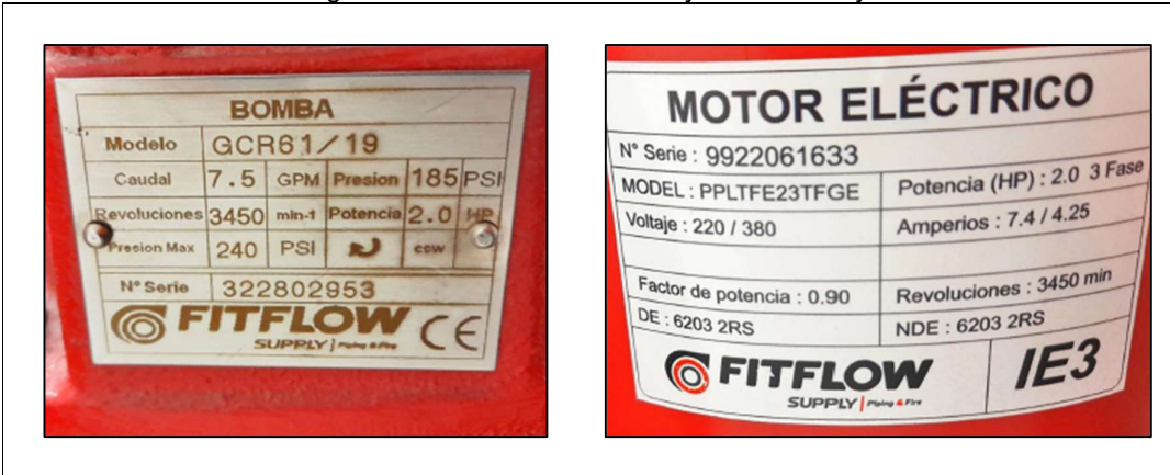
Figura 3.9 Placas de la bomba y motor Jockey
