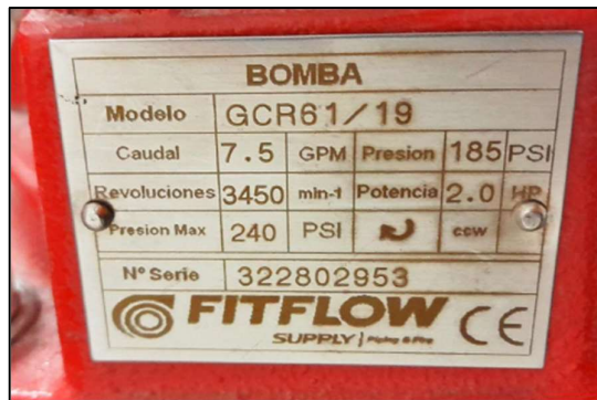
Figura 3.4 Placa de la bomba Jockey instalada
