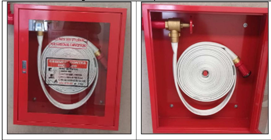
Figura 3.18 Gabinete tipo II adosado
