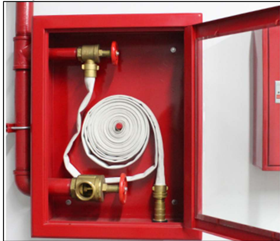
Figura 2.11 Gabinete contra incendio clase III
