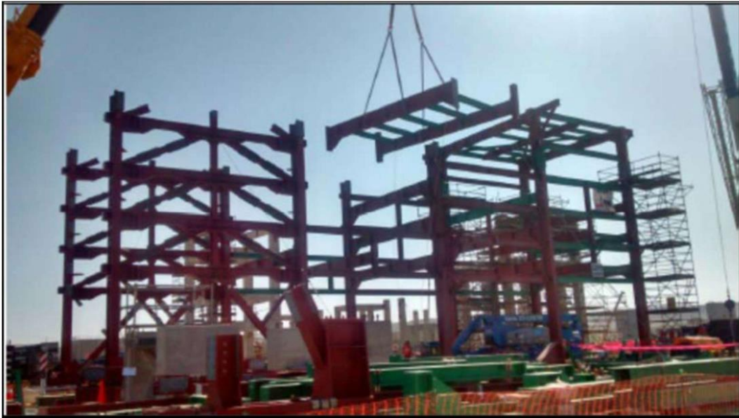
Figura 26 Paso 3: Falta de suministro de elementos en pipe racks
