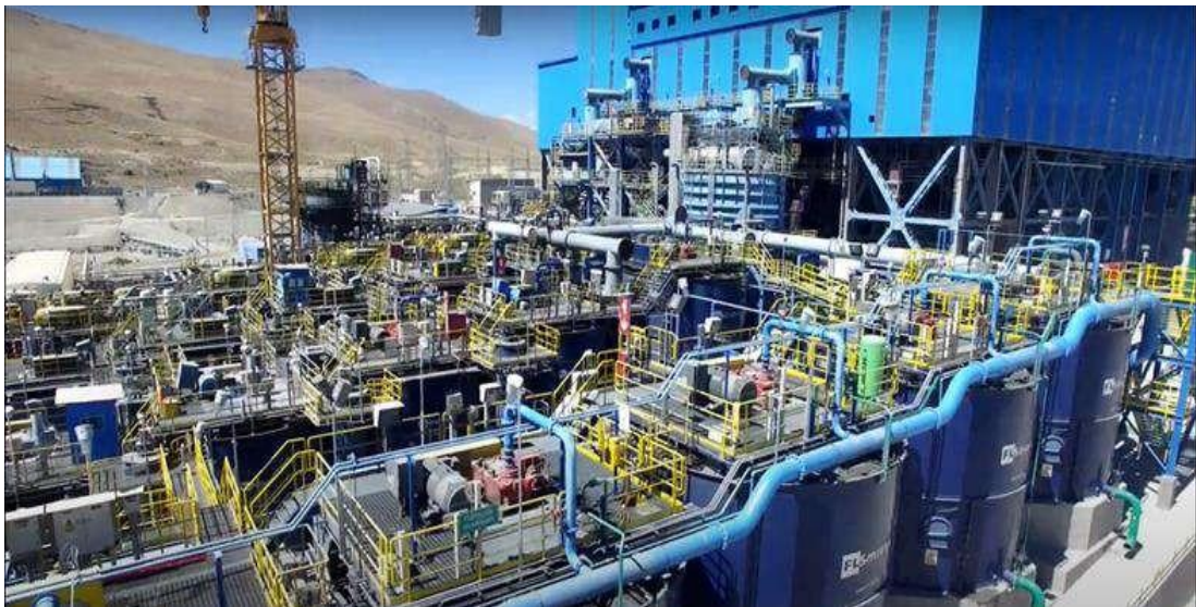
Figura 2.15 Vista lateral de circuito de flotación
