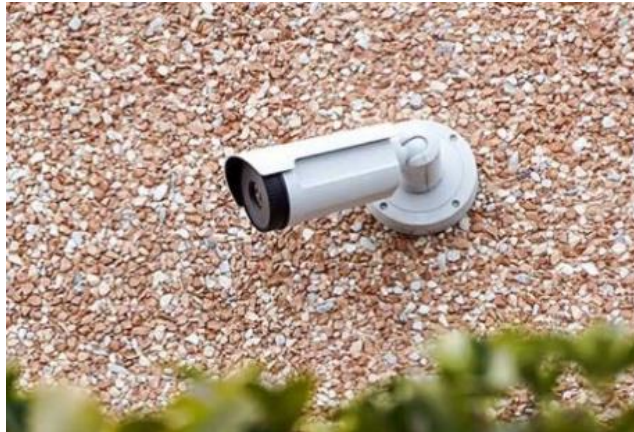
Figura N° 15. Cámara de video vigilancia tipo Bullet.
