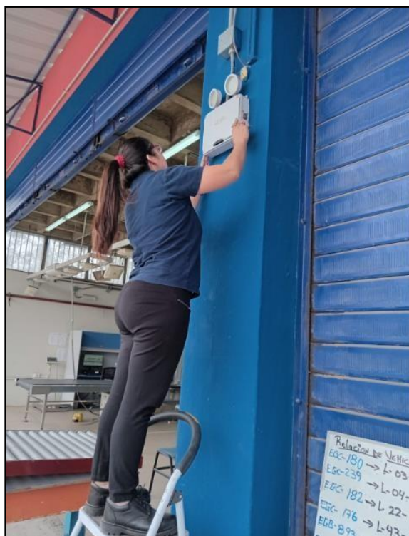
INSPECCIÓN DE LUCES DE EMERGENCIA
