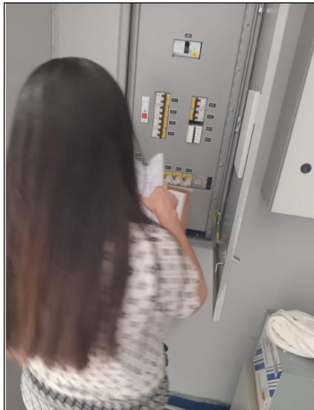
INSPECCIÓN DE TABLEROS
