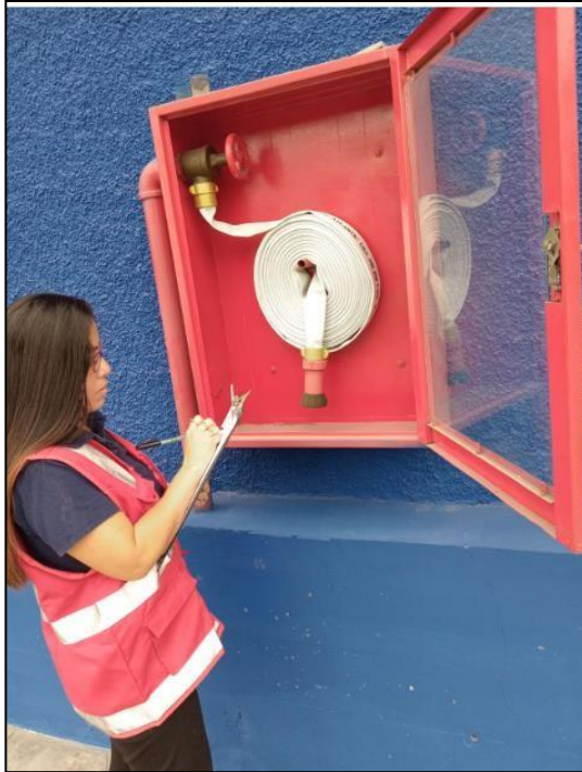
INSPECCIÓN DE MANGUERAS CONTRA INCENDIOS
