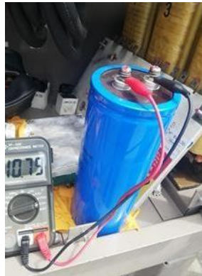
Figura 2 BANCO DE CAPACITORES
