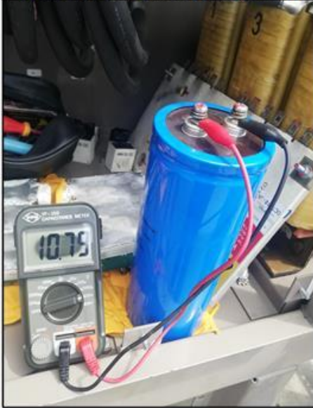
PRUEBA DE CAPACITORES:10,700MF
