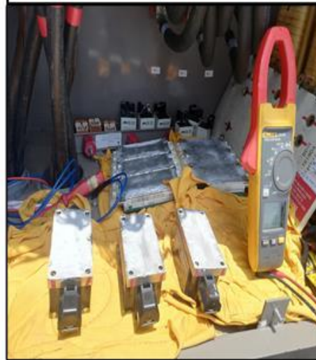
PRUEBA DEL MODULO CONVERTIDOR
