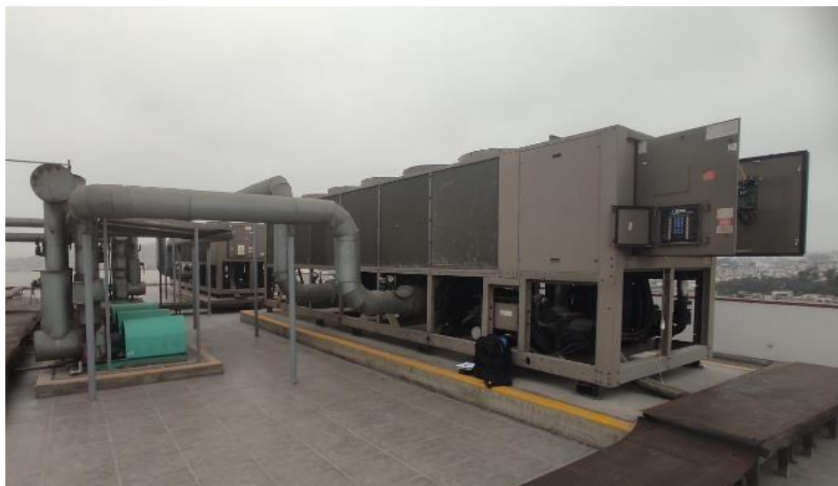
Figura 1 TORRE DE ENFRIAMIENTO PISO 12
