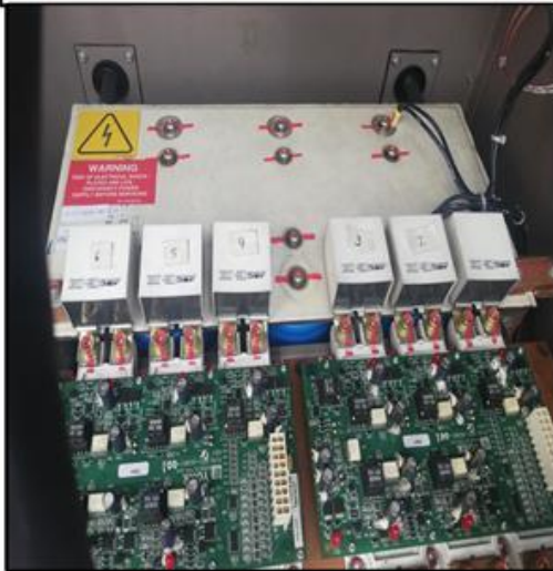
MEDICIONES EN CAPACITORES DE POTENCIA DEL VSD Y PRUEBA DE MODULOS
