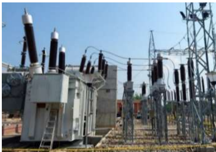
Figura 2.2 Celda de transformación de una SEP
