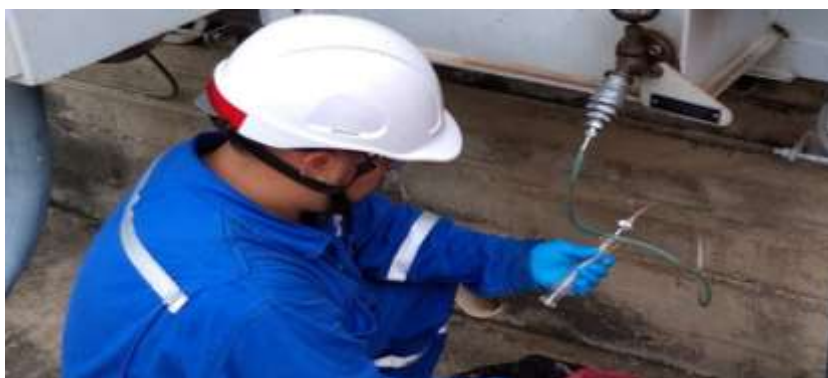
Figura 2.9 Toma de muestra de aceite de transformador
