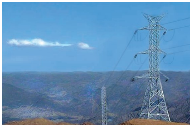
Figura 11. Línea de transmisión de 220 kV, Mantaro – Cotaruse
