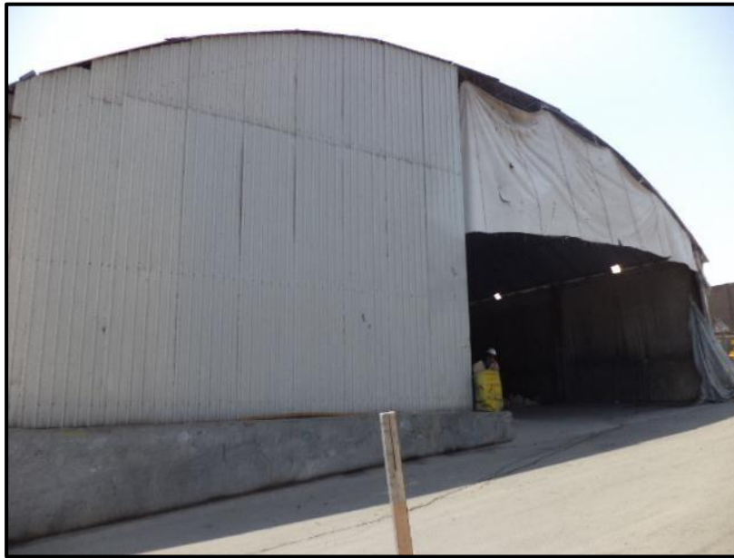
CABINA DE PINTURA, VISTA EXTERIOR – TALLER AZOLER
