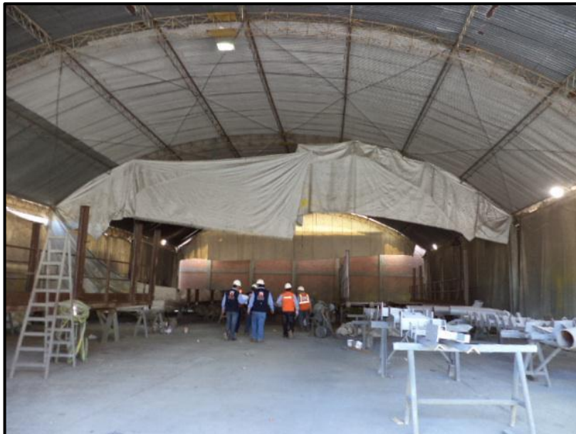
CABINA DE PINTURA, VISTA INTERNA – TALLER AZOLER
