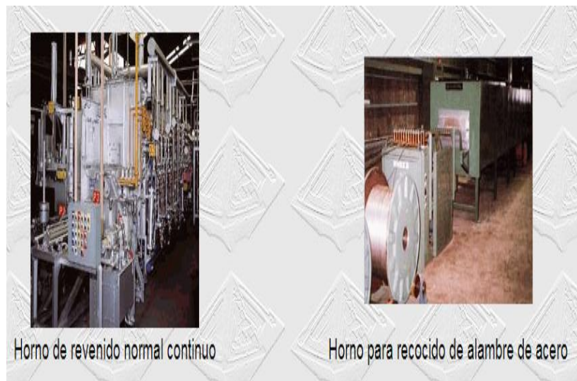
Figura 2.2.11 Hornos para tratamiento térmico
