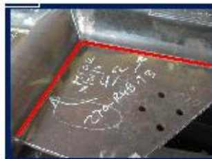
FOTO 2: Se observa los tramos del Empalme 2, Inspeccionado mediante partículas magnéticas vía seca, los cuales no presentan discontinuidades relevantes.
