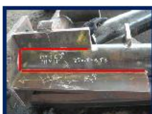
FOTO 6: Se observa los tramos del Empalme 4, Inspeccionado mediante partículas magnéticas vía seca, los cuales no presentan discontinuidades relevantes.
