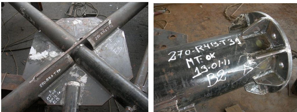
Fig. N° 4.25 Elementos con indicacion aceptable en ensayo MT
