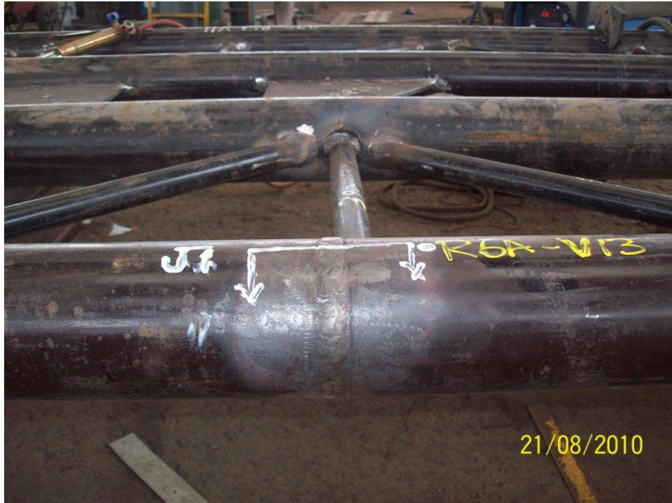
Fig. N° 4.26 Elementos con indicación de referencia en ensayo RT
